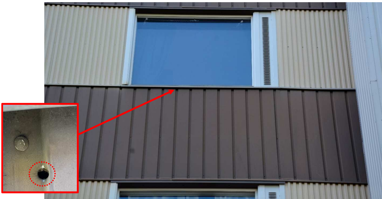
Figur 5. Fasaden och det aktuella sovrumsfönstret. Den inåtgående cirkulära skadan är markerad.
