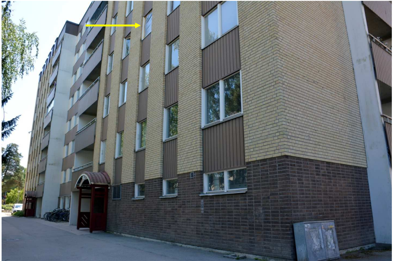
Bild 1. Byggnadens utsida, aktuellt fönster markerat med gul pil.
