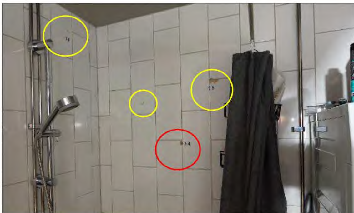
Figur 18. Skadorna i kaklet i duschen. En del av skadorna är markerade med gula ellipser. Den röda ellipsen markerar en skada där en kula sitter kvar i väggen.
