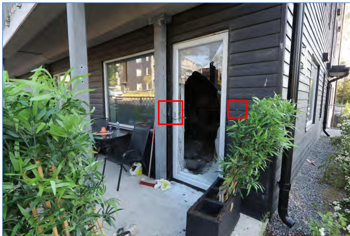
Figur 9. På stålpelaren och i väggen i området kring altandörren iaktas skador som bedöms utgöra islagsmärken. Islagsmärkena är utmarkerade med rutor.
