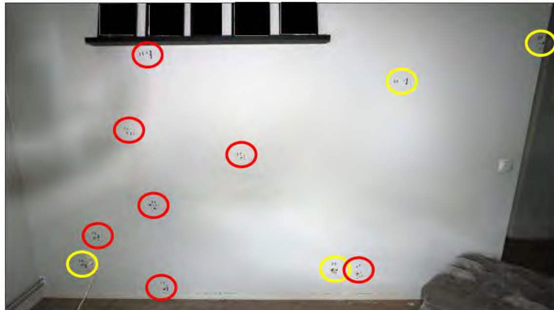
Figur 12. Väggen bakom soffan i vardagsrummet/köket. De sju genomgående skottskadorna är markerade med röda ellipser. De gula ringarna markerar skottskador som inte var genomgående.
