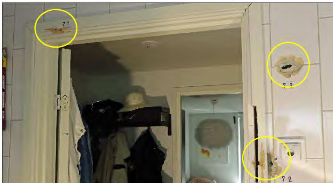
Figur 17. Inne i badrummet. De genomgående skottskadorna från hallen in i badrummet markerade med gula ellipser.
