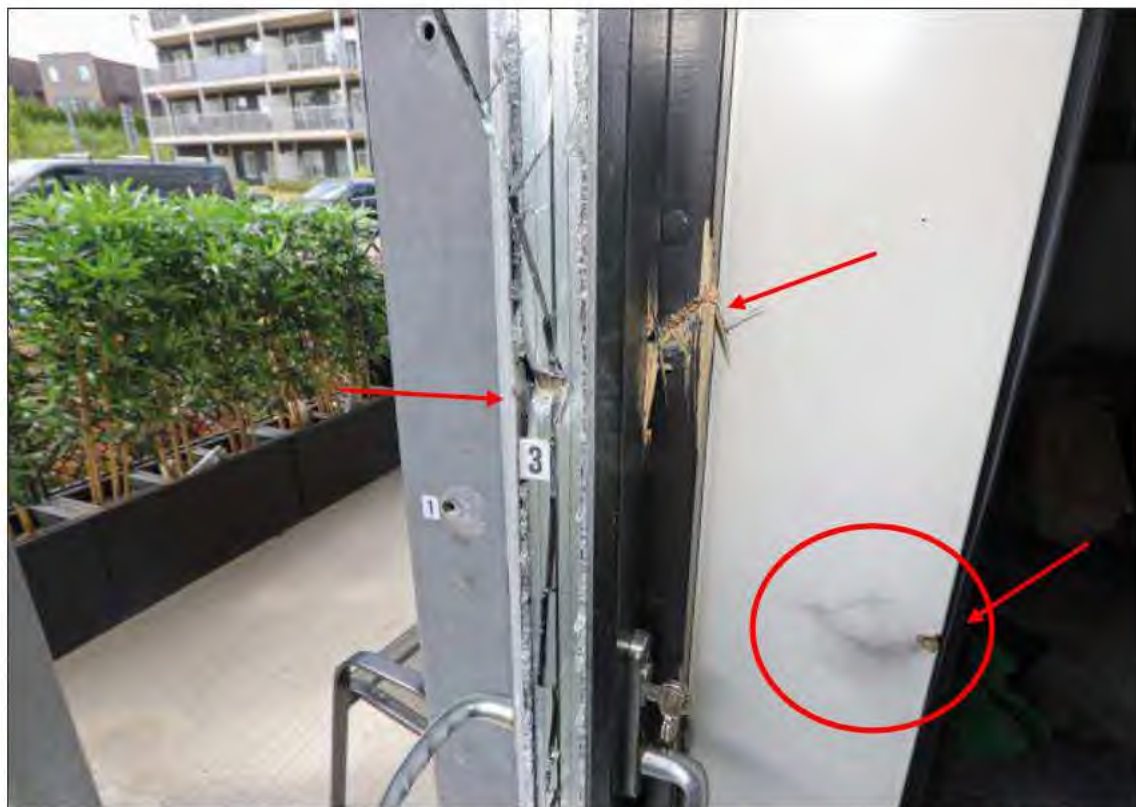
Figur 6. Väggen på insidan av altandörren. Pilarna markerar skottskador. Den röda ellipsen markerar skottrester.
