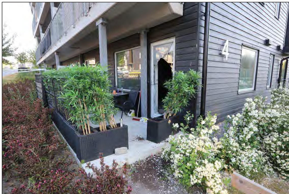
Figur 6. Altanen tillhörande aktuell lägenhet. Altandörrens glastrutor är krossade.
