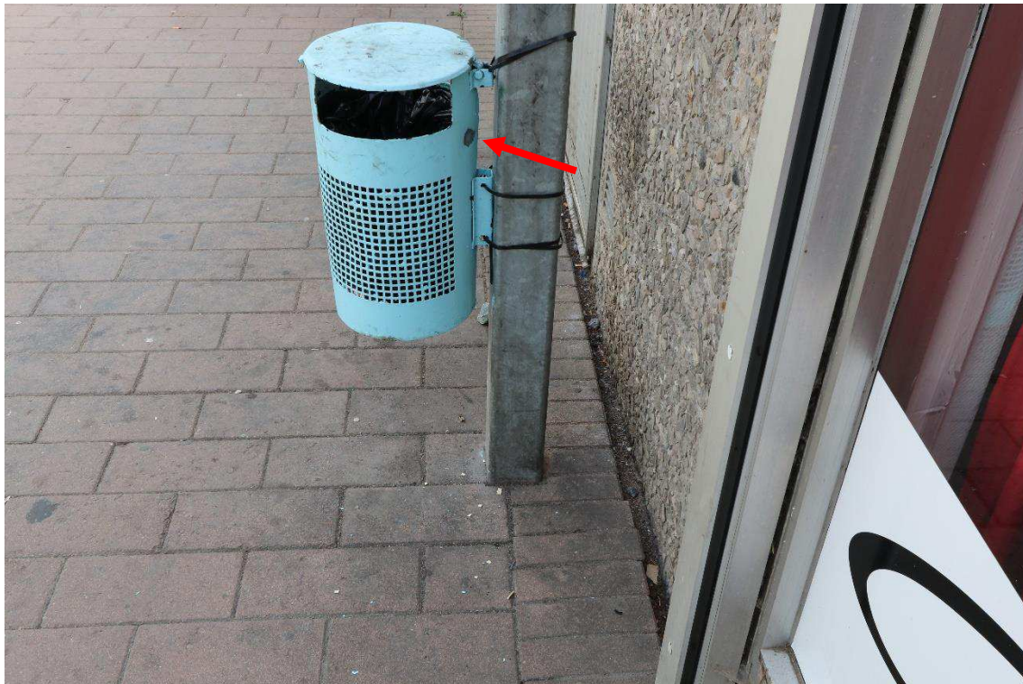
Foto 4, Soptunna på pelare. Skadans placering markerad med pil
