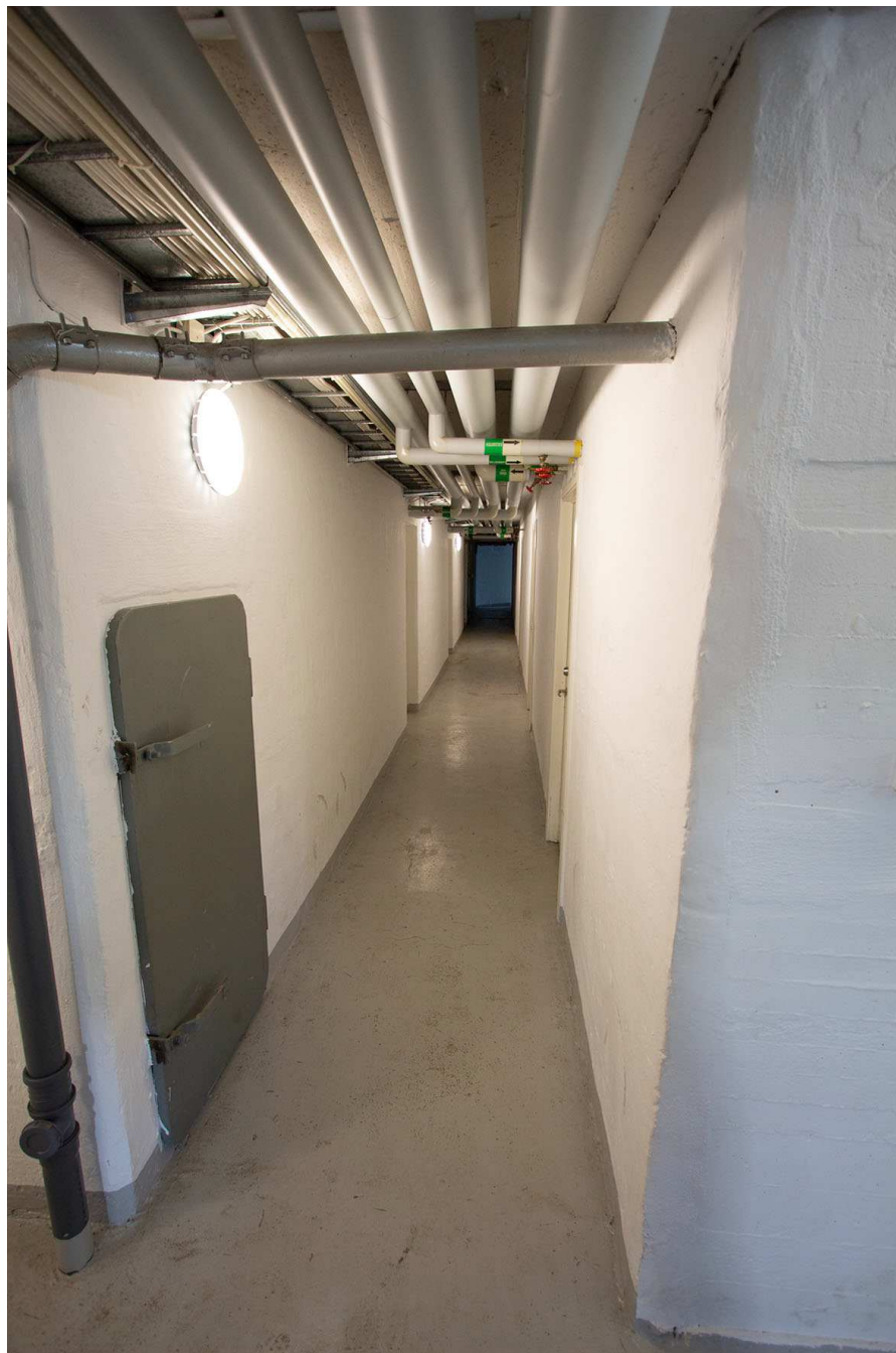
Figur 2. Källargången. En kabelstege ses högst upp till vänster i bild.
