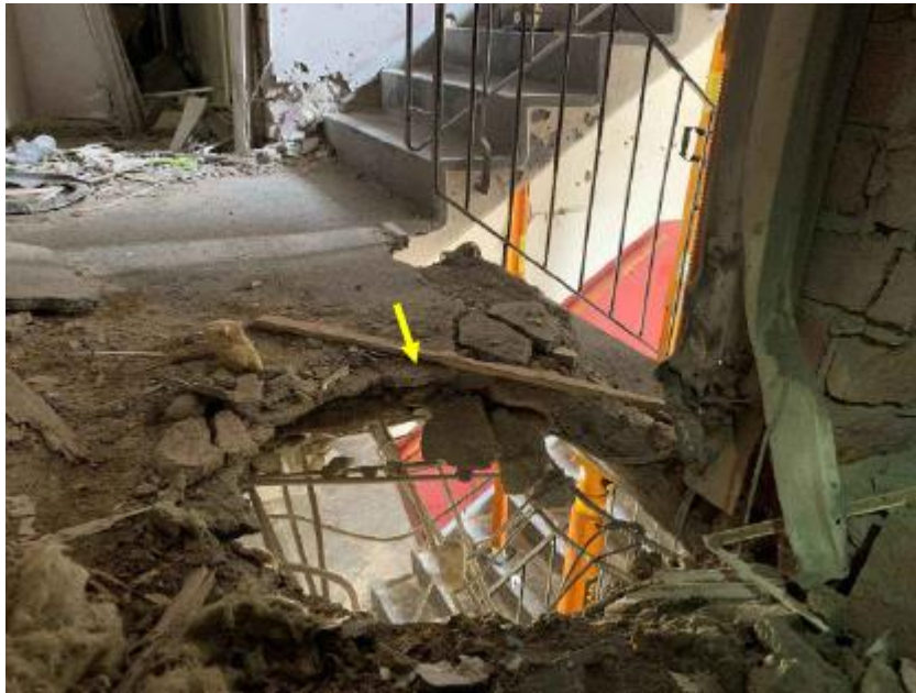
Bild ur förundersökningsprotokollet. Bilden är tagen inifrån lägenhet 1101 och visar det genomgående hålet i golvet utanför lägenheten.
