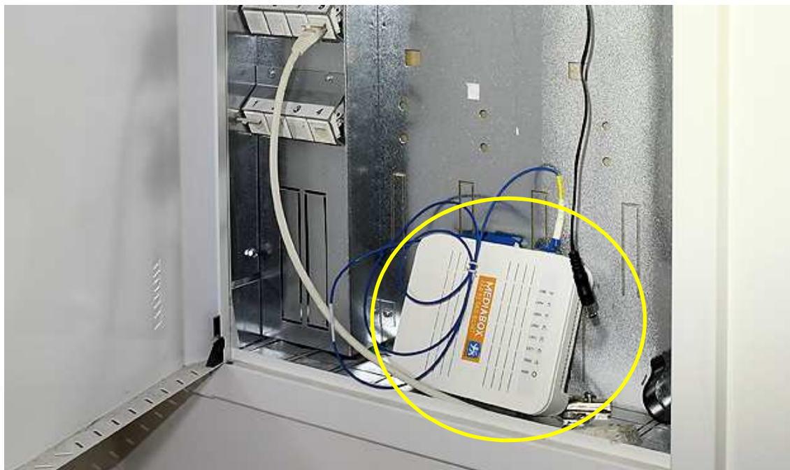
Figur 7. En del av elskåpet, där den strömlösa routern är markerad.
