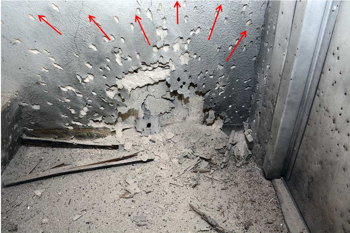
Figur 18. Skador på väggen där skadornas form visar en radiell spridning med detonationsplatsen som ursprung. Riktningen på ett urval av skadorna är markerade.
