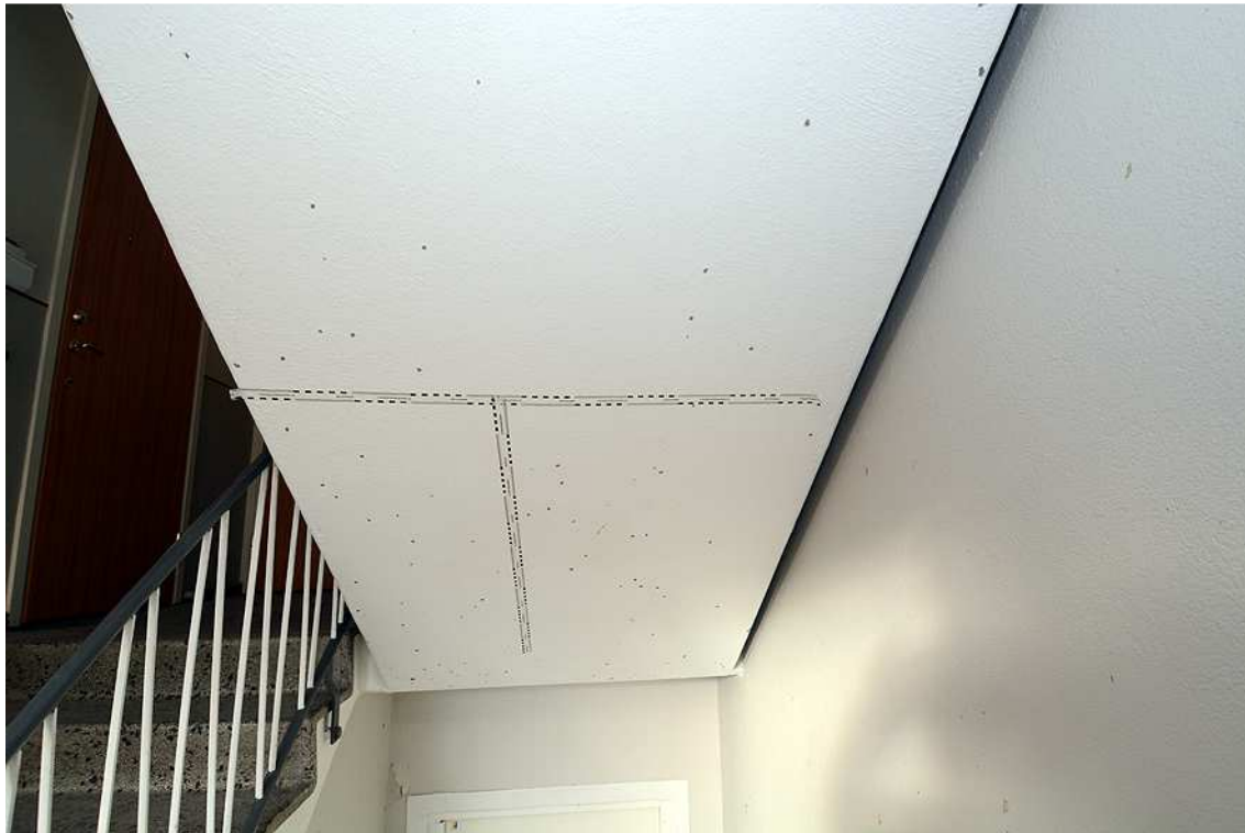
Figur 20. Skadorna ovanför detonationsplatsen upp mot entrén.
