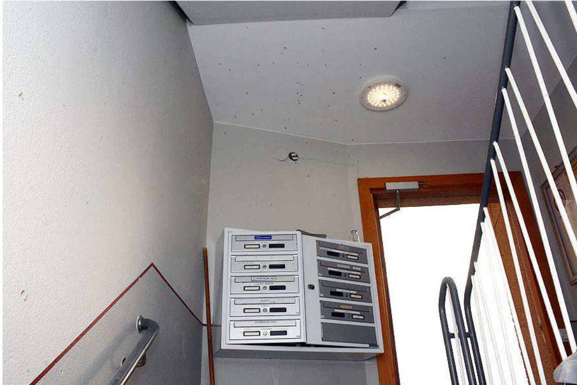
Figur 22. Skador på tak och väggar i anslutning till entrén.
