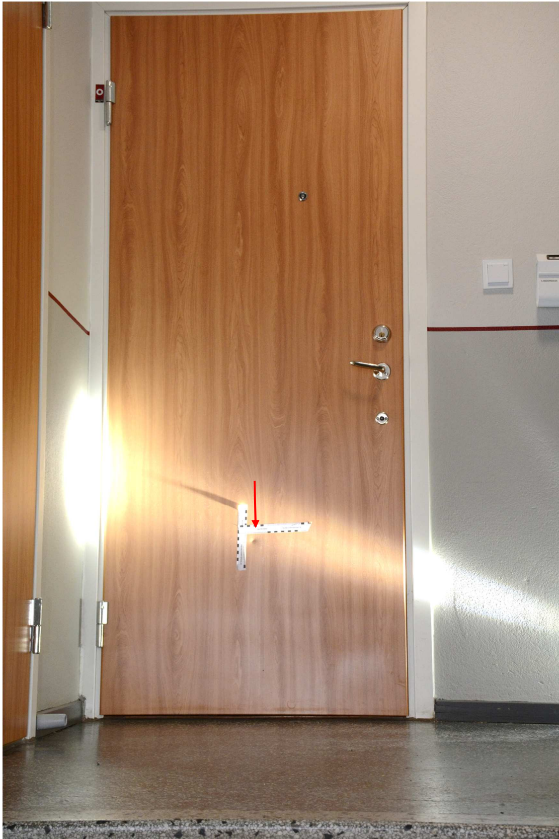
Figur 2. Samma dörr som figur 1 där skadan är markerad och belyst med ljuskälla från sidan.
