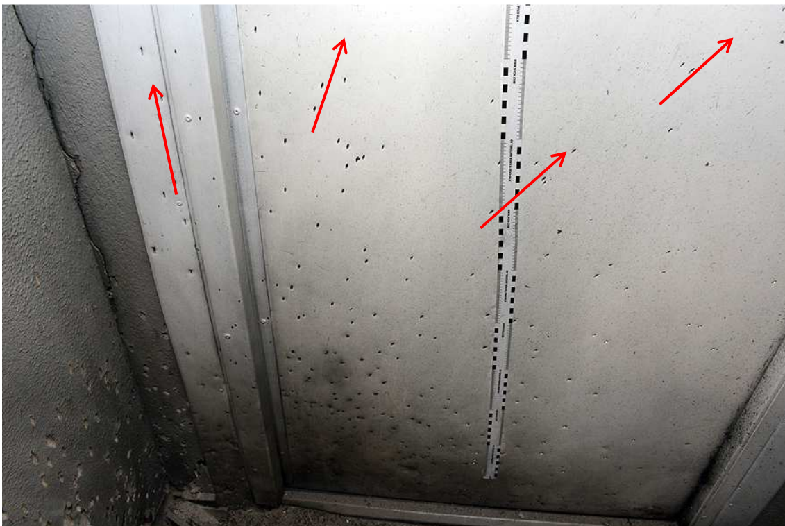
Figur 19. Skador på dörren där skadornas form visar en radiell spridning med detonationsplatsen som ursprung. Riktningen på ett urval av skadorna är markerade.
