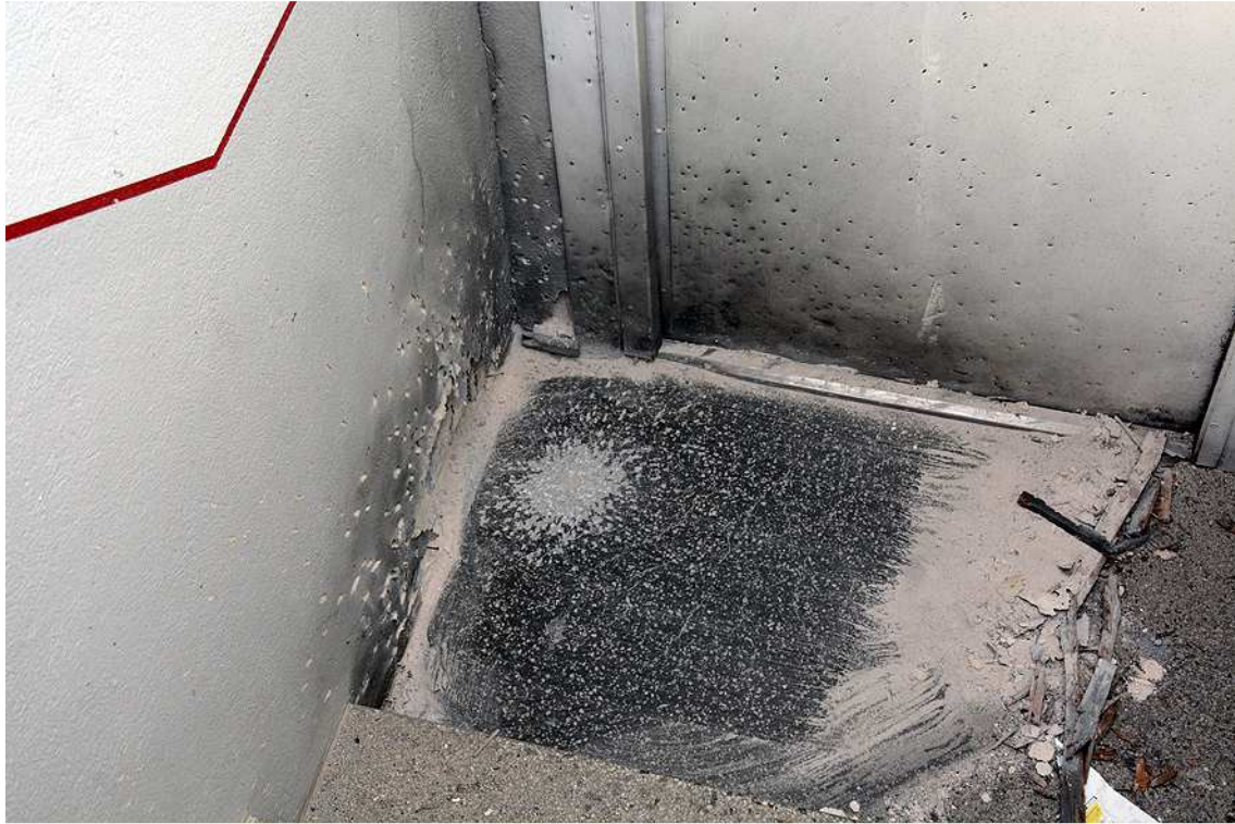
Figur 16. Detonationsplatsen efter att golvet frilagts. På bilden ses även skador på vägg och dörr.
