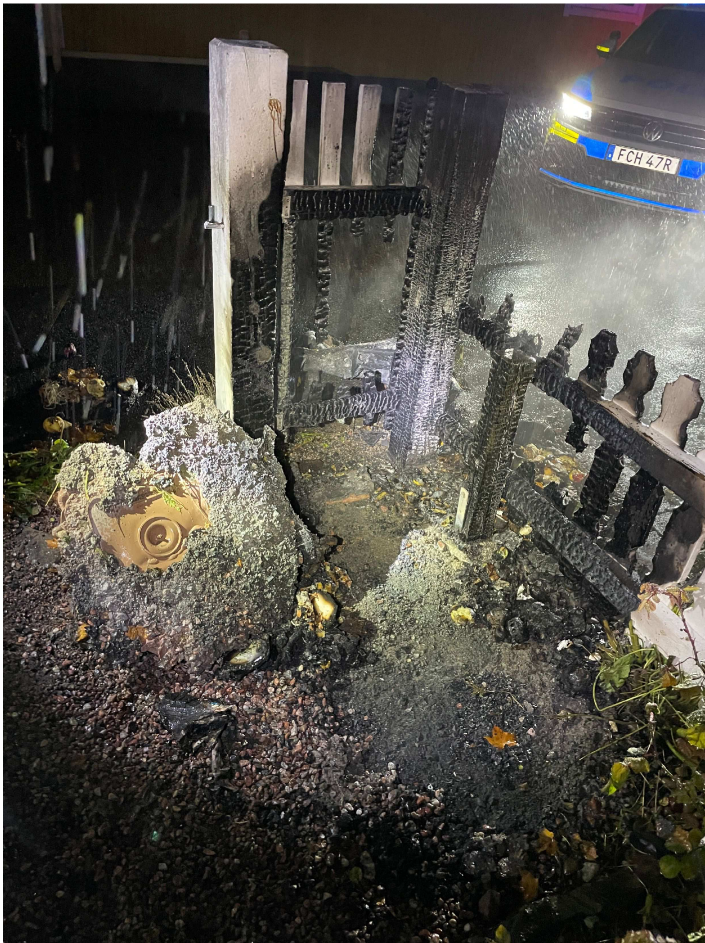
11. Bild föreställande två nedbrunna soptunnor samt ett brandskadat staket. /Pa Spegel- Nääs
