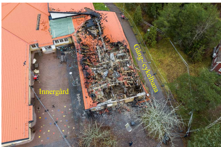
Figur 4. UAS-foto över den brandskadade huskroppen.
