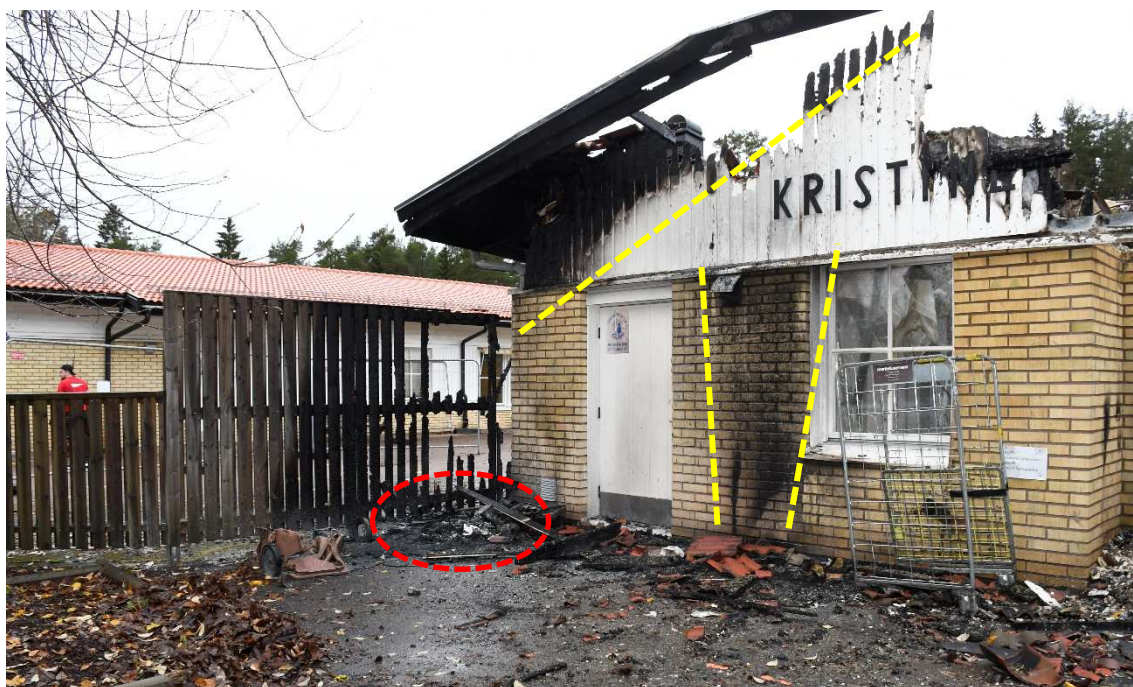
Figur 5. En del av huskroppens södra fasad och det träplank som fanns i anslutning till fasaden. En brandhård är markerad med röd ring. De gula streckade linjerna markerar ett halvt brand-v och ett fullständigt brand-v.
