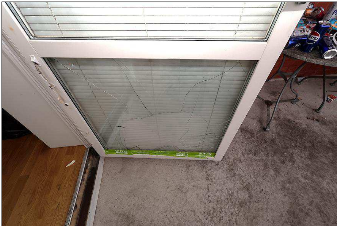
Figur 20. Balkongdörren med en skada i den nedre glasrutan.
