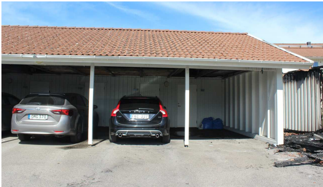
Figur 7. Carporten som klarade sig från branden. Till höger kan den nedbrunna carporten skymtas.
