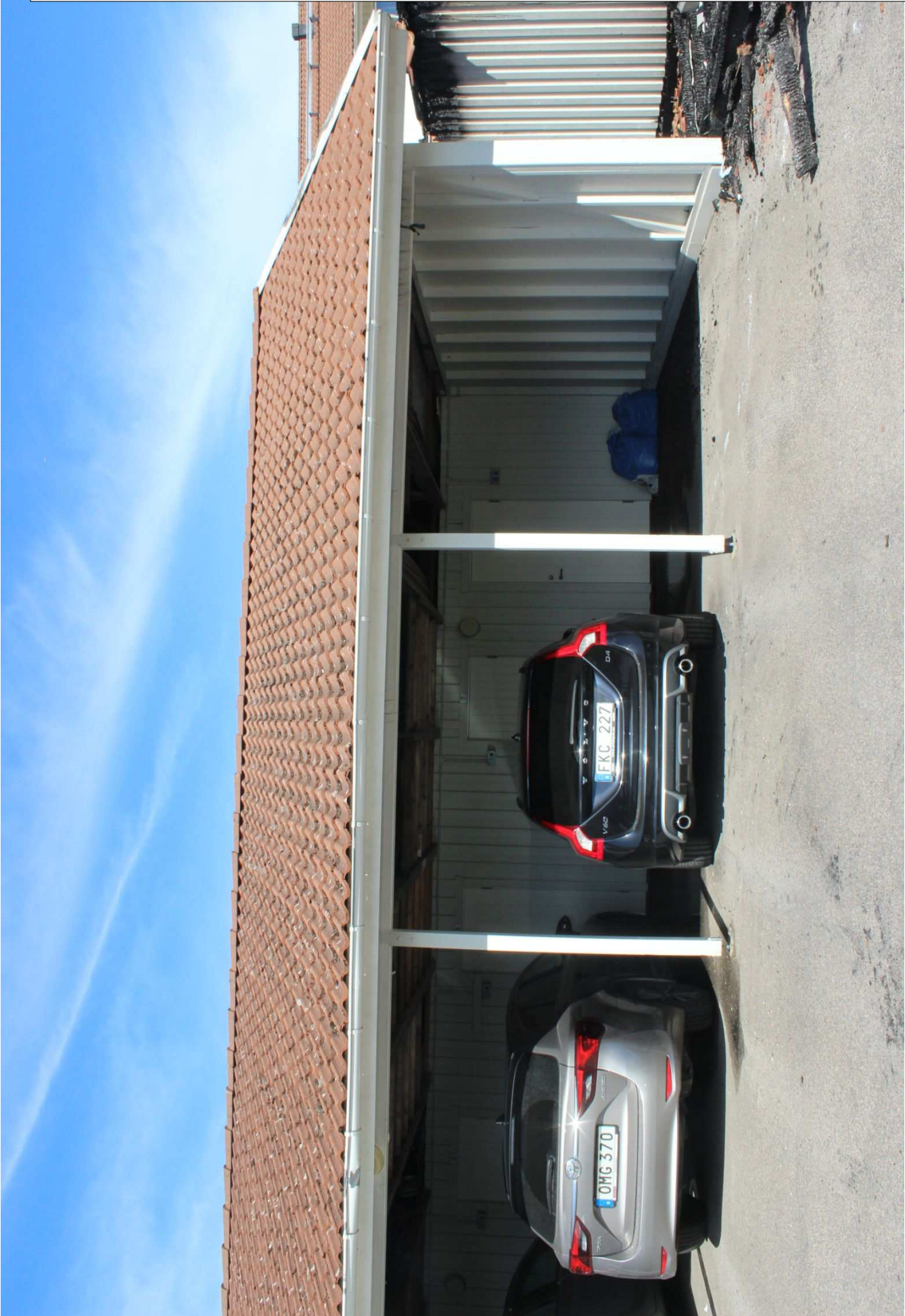
Carporten bredvid. Ska ha varit byggd på samma sätt. Denna hade dock fem bilplatser, den som brunnit hade sex platser.
