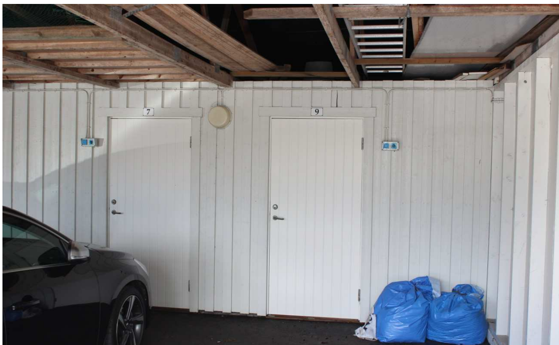
Figur 8. Förrådsdel och vägguttag.
