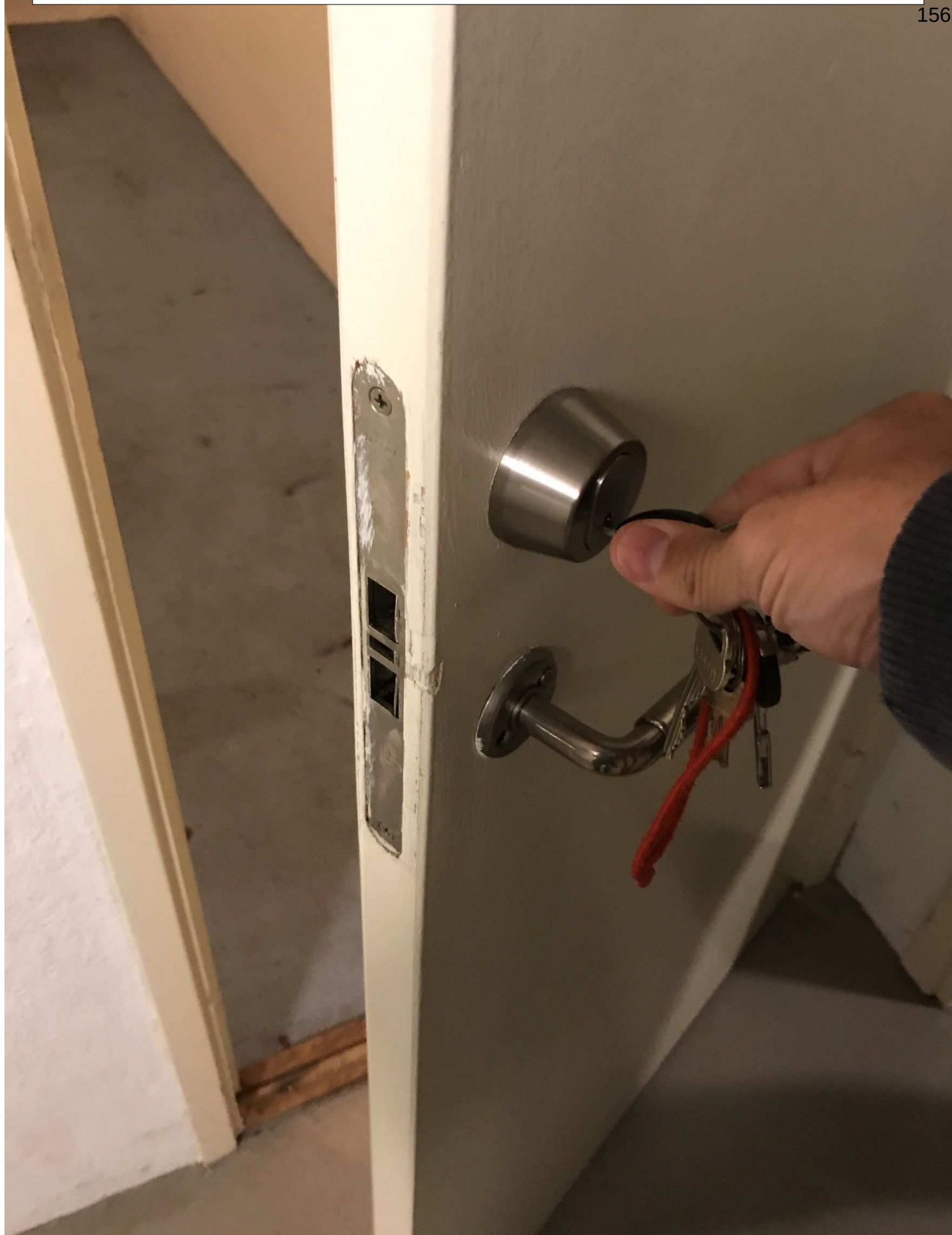
2. Barnvagnsförråd, Studentv 8. Öppnas med iLOQ S6115
