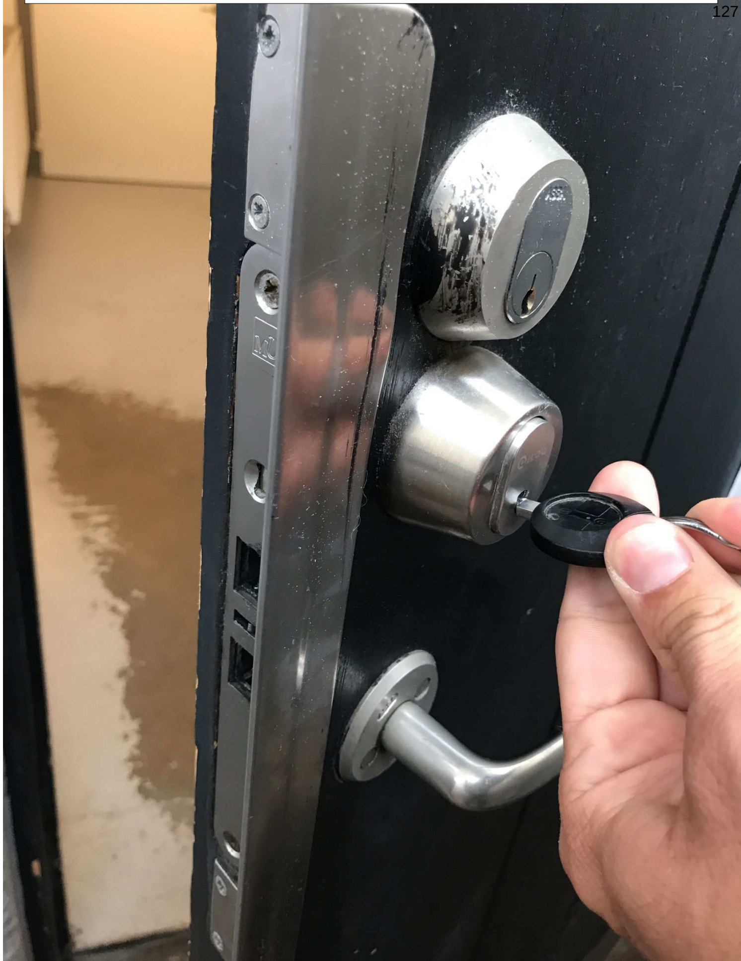
5. Ytterdörr till källare, Studentv 2-10. Öppnas med Getoarbs nyckel iLOQ S6115
