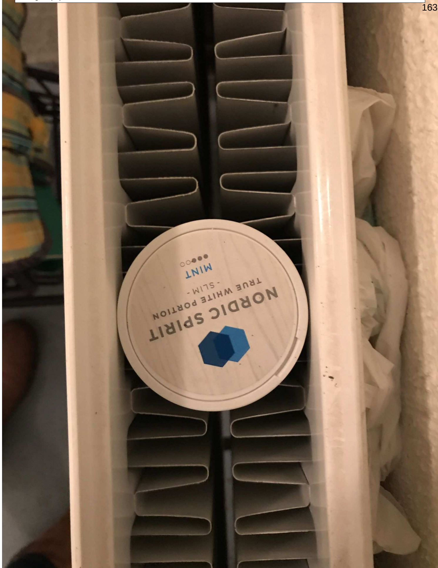
9. BG86613-2. Punkt 1 (plastpåse) ses inkilad mellan element och väggen
