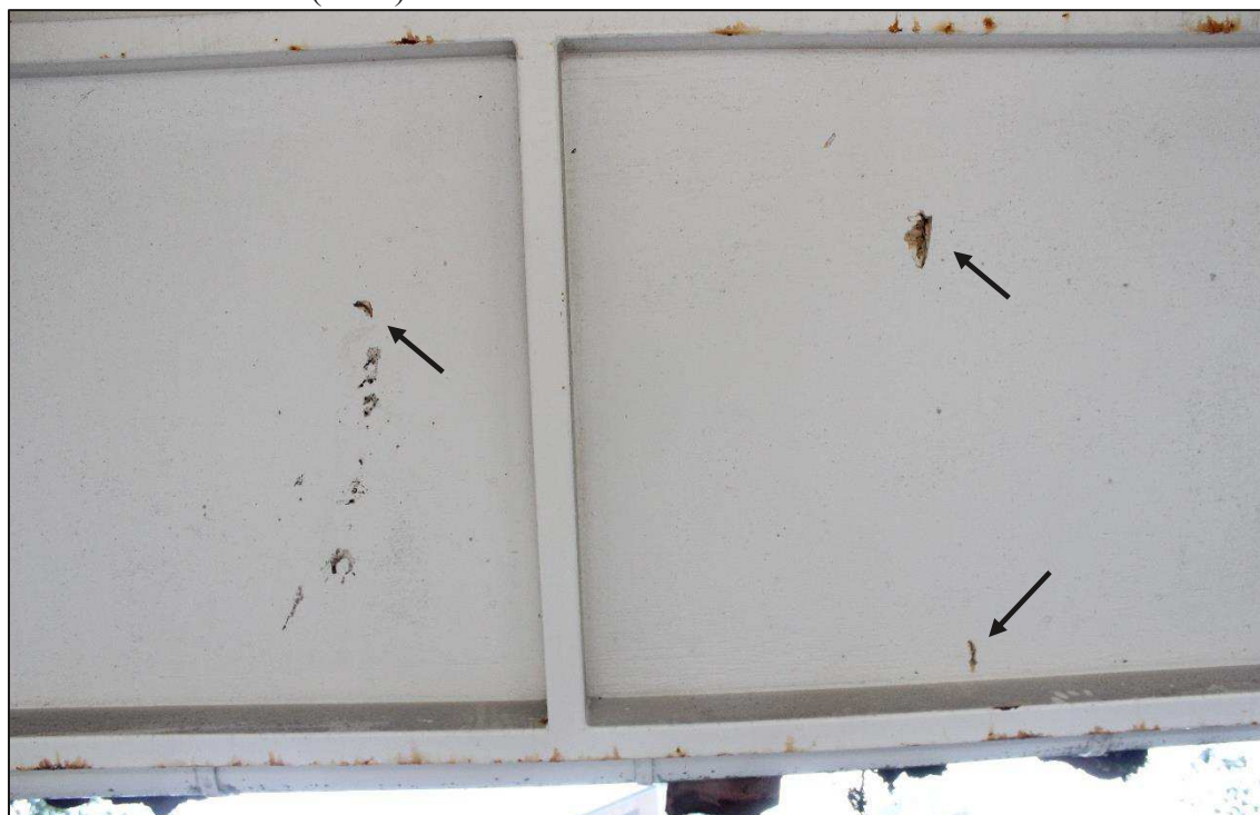
Figur 7. Skador på undersidan av taket.
