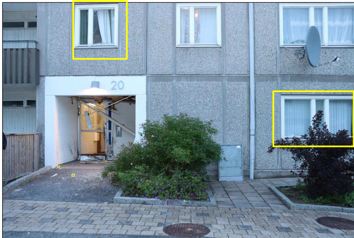
Figur 6. Entrén till Baron Rogers gata 20. Gula fyrkanter markerar skadade fönster.
