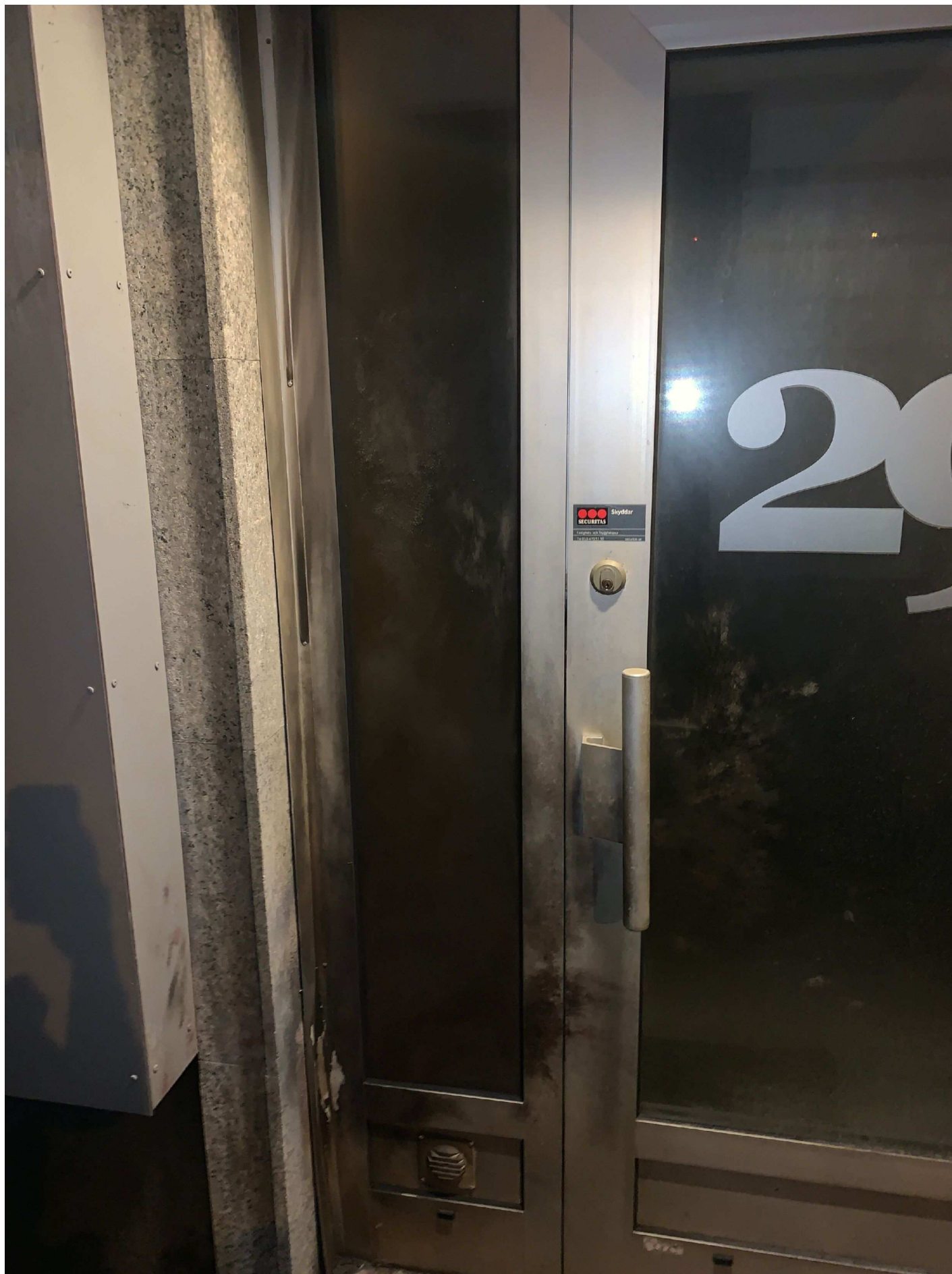
3. Närbild över skada från misstänkt explosion.
