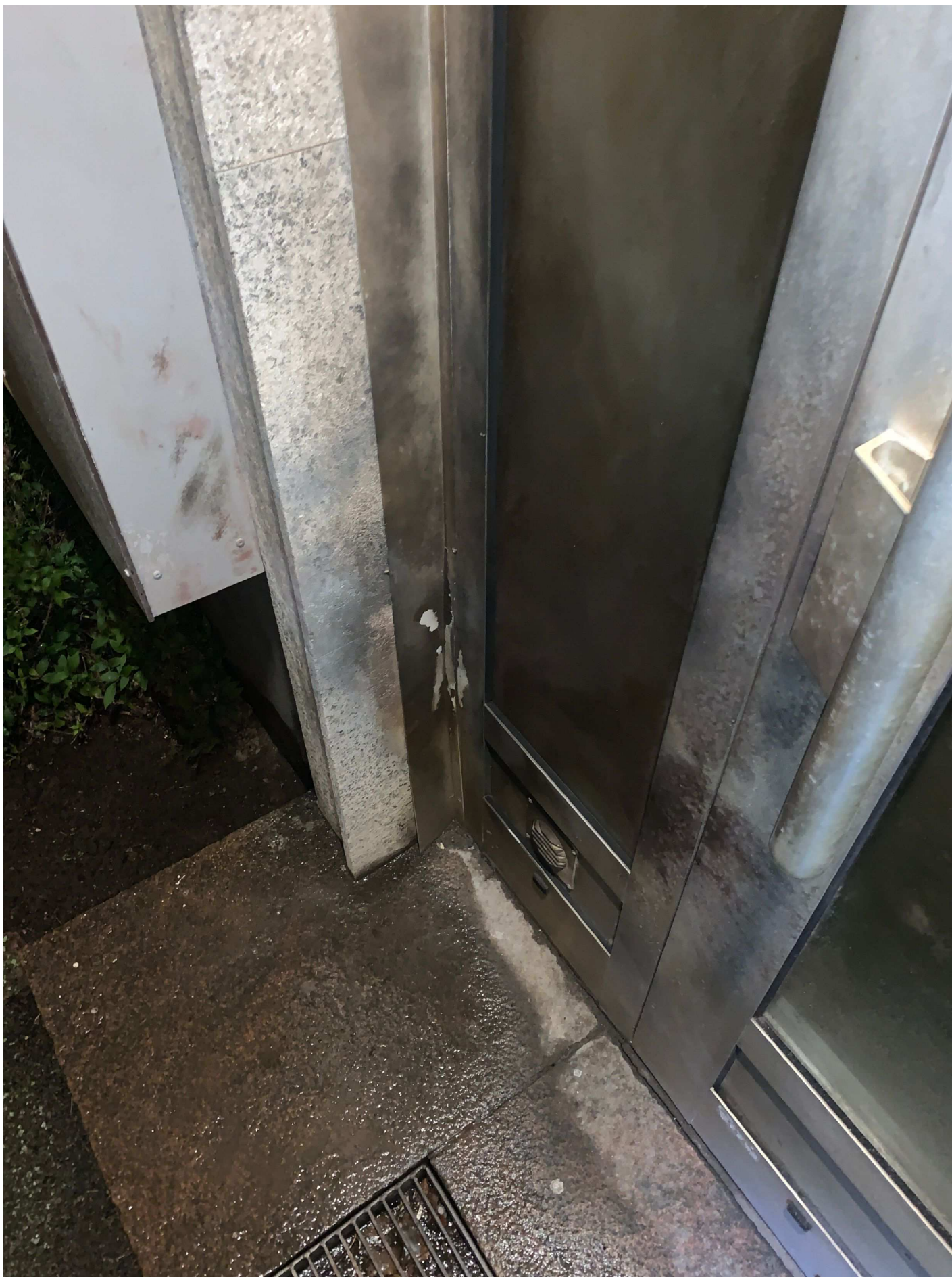
4. Närbild över skada från misstänkt explosion.
