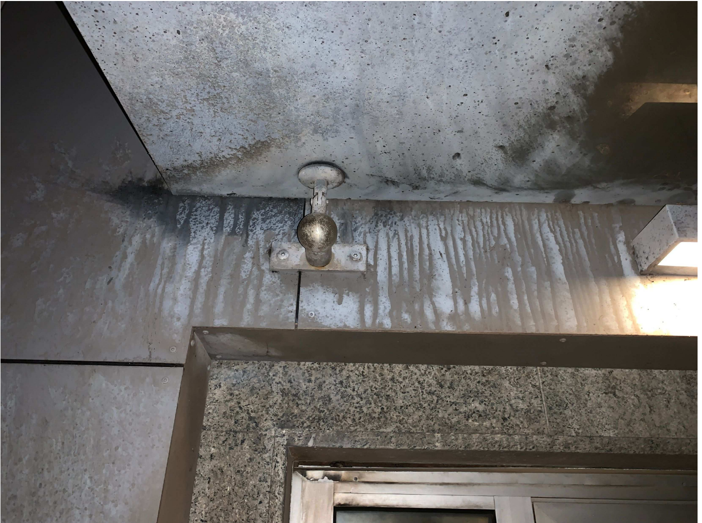
6. Foto på övre dörr samt tak till entre.
