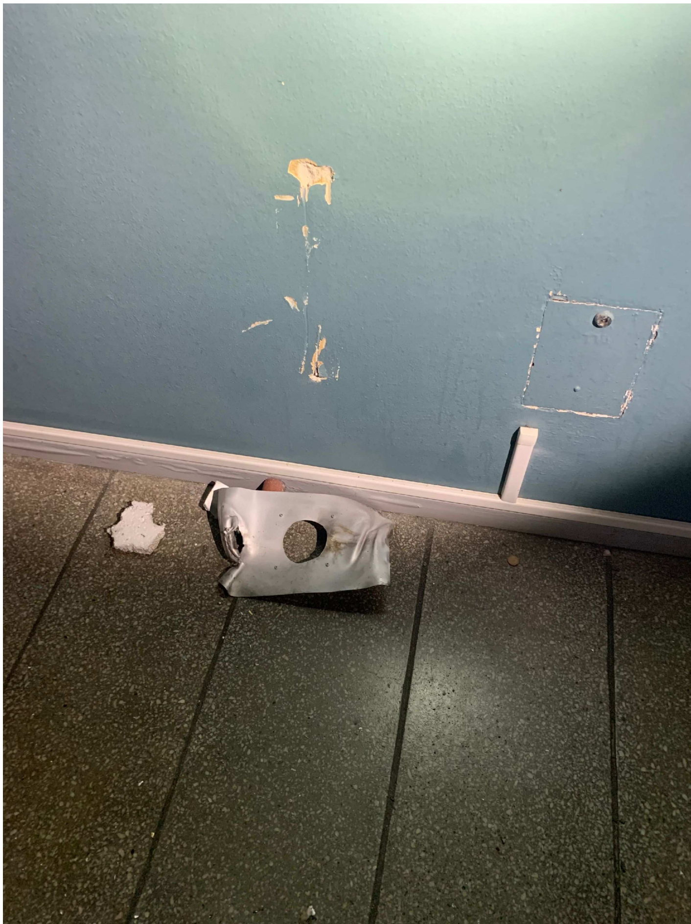
7. Detaljbild av skadorna på väggen på våningsplan 1.
