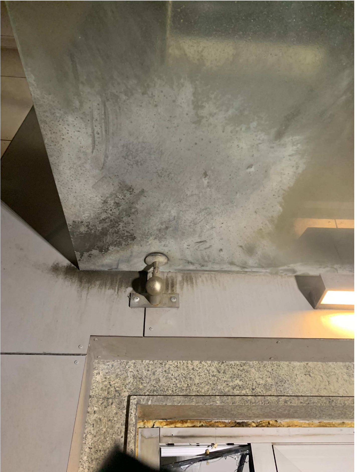
4. Sotning på undersidan av entréns glastak. Rakt ovanför IED:ns placering
