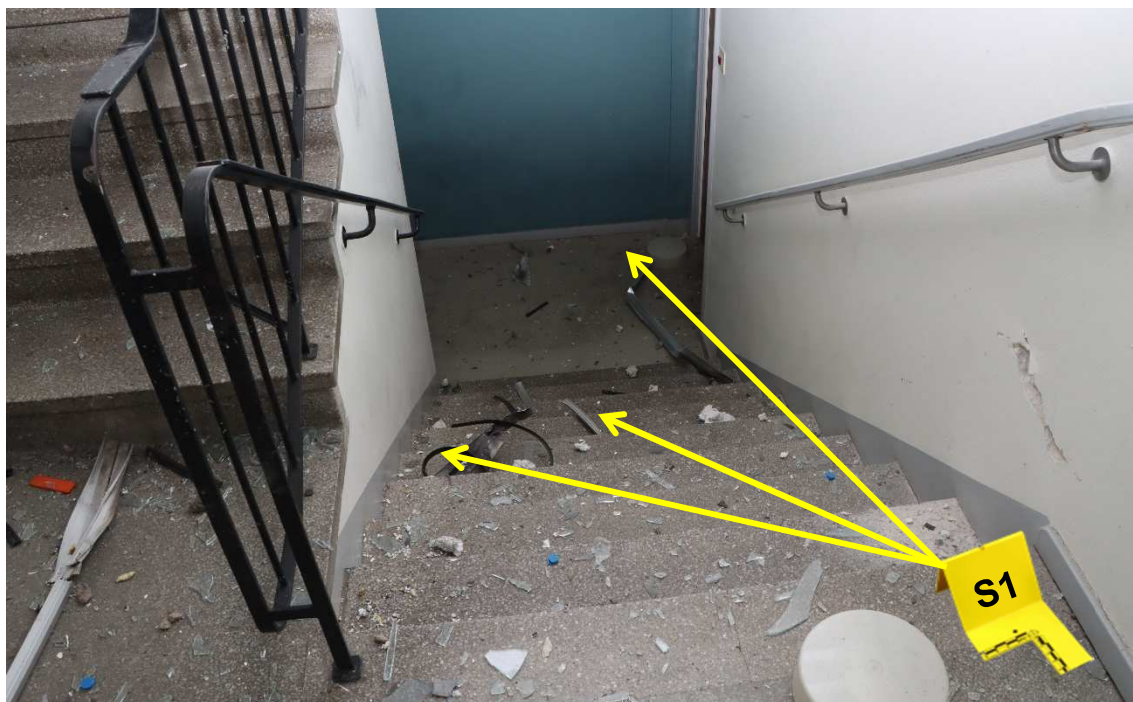
Figur 4. Trapphuset med de nedfallna glaskuporna.
