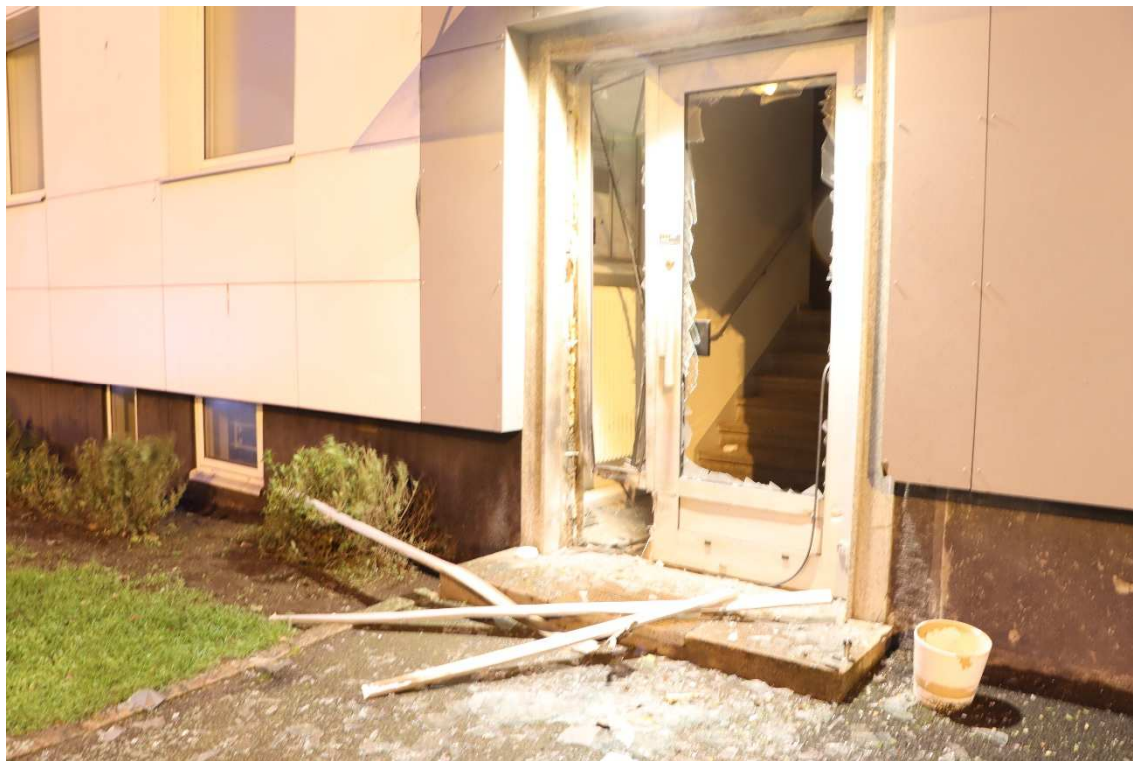
Figur 3. Skadorna på entrén och dess omgivning.
