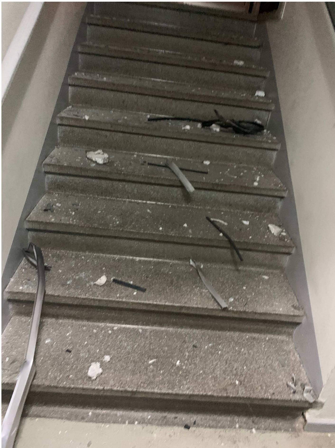
9. Splitter och sekundärsplitter i trappan ner till källaren. Bild tagen från källarplan upp mot entrén.
