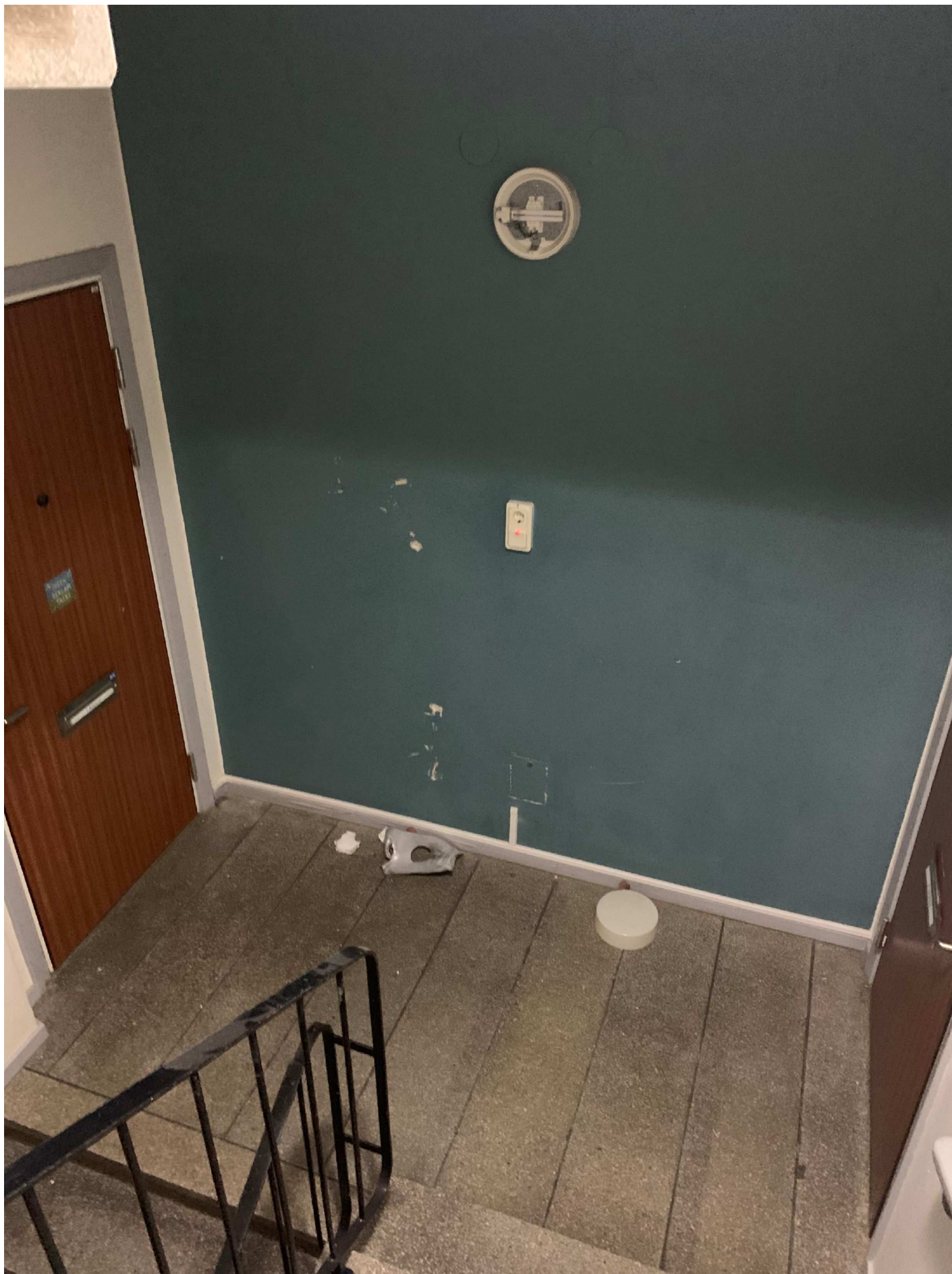
6. Översiktsbild tagen från en halvtrappa ovanför våningsplan 1. Notera skadorna i väggen orsakat av splitter från explosionen.
