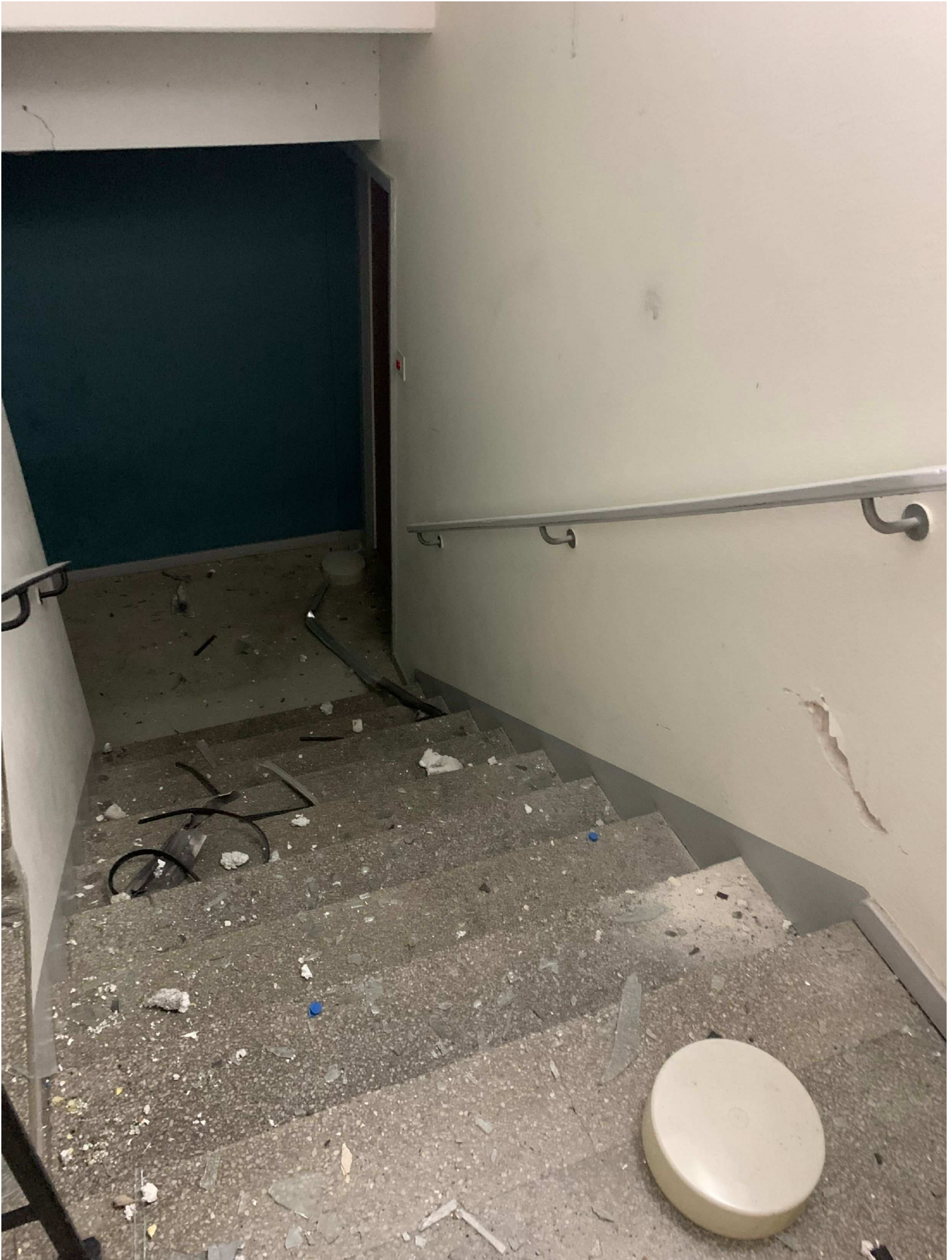
8. Översiktsbild från entrén ner mot källarplan. Notera skadan på väggen till höger, under räcket, där splitter från explosionen träffat.
