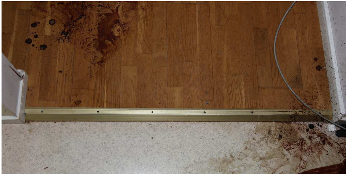
Figur 12. Foto mot metallisten innan den skruvades av.
