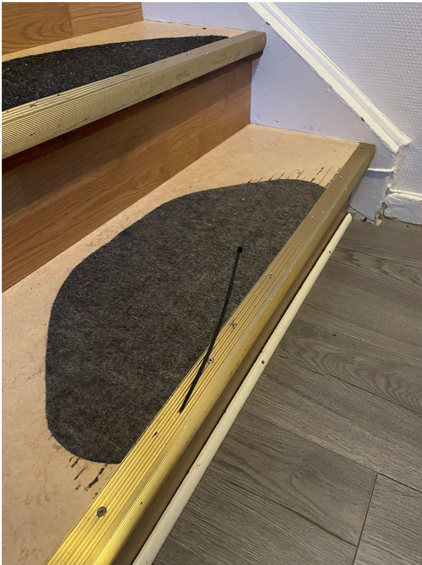
8. Buntband i trappen som leder till övervåningen hemma hos målsäganden.
