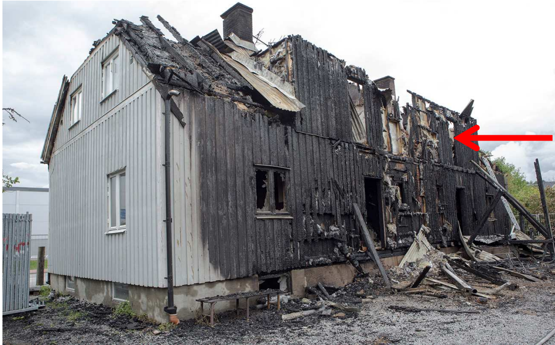
Bild 3. Östra gaveln och norra sidan av fastigheten, Fältgatan 8, Arvika. Trapporna till samtliga lägenheter totalt bortbrända. Röd pil markerar entré till aktuell lägenhet.
