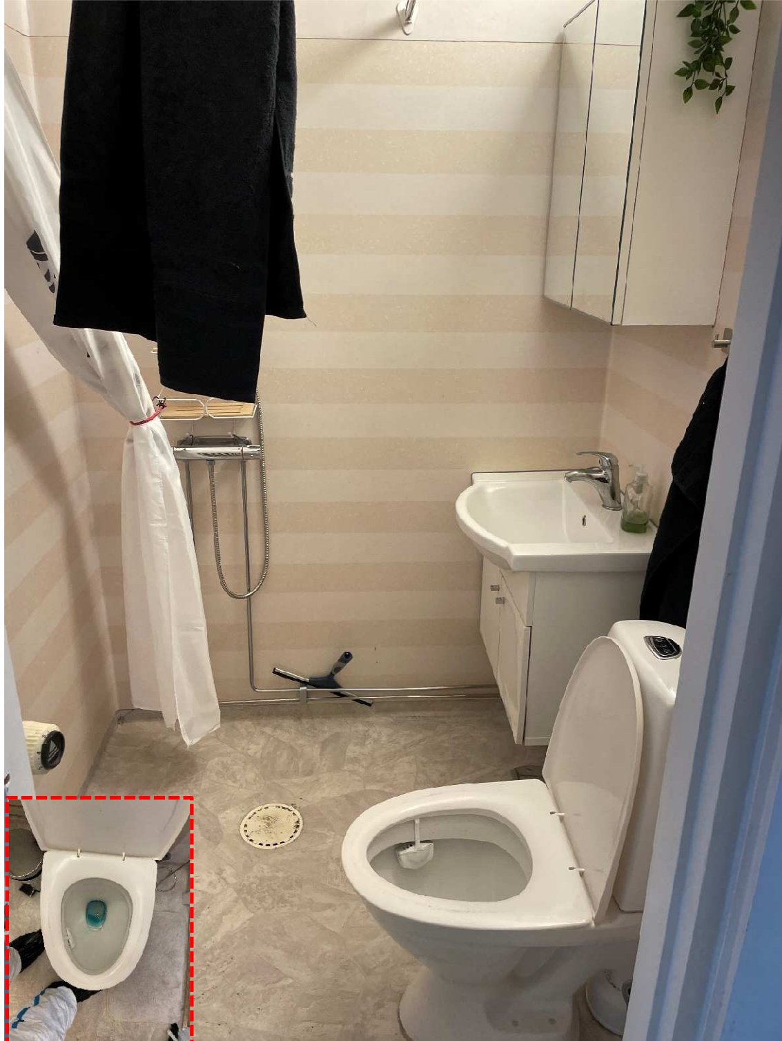
Figur 10. I den infällda bilden ses toalettskålen.
