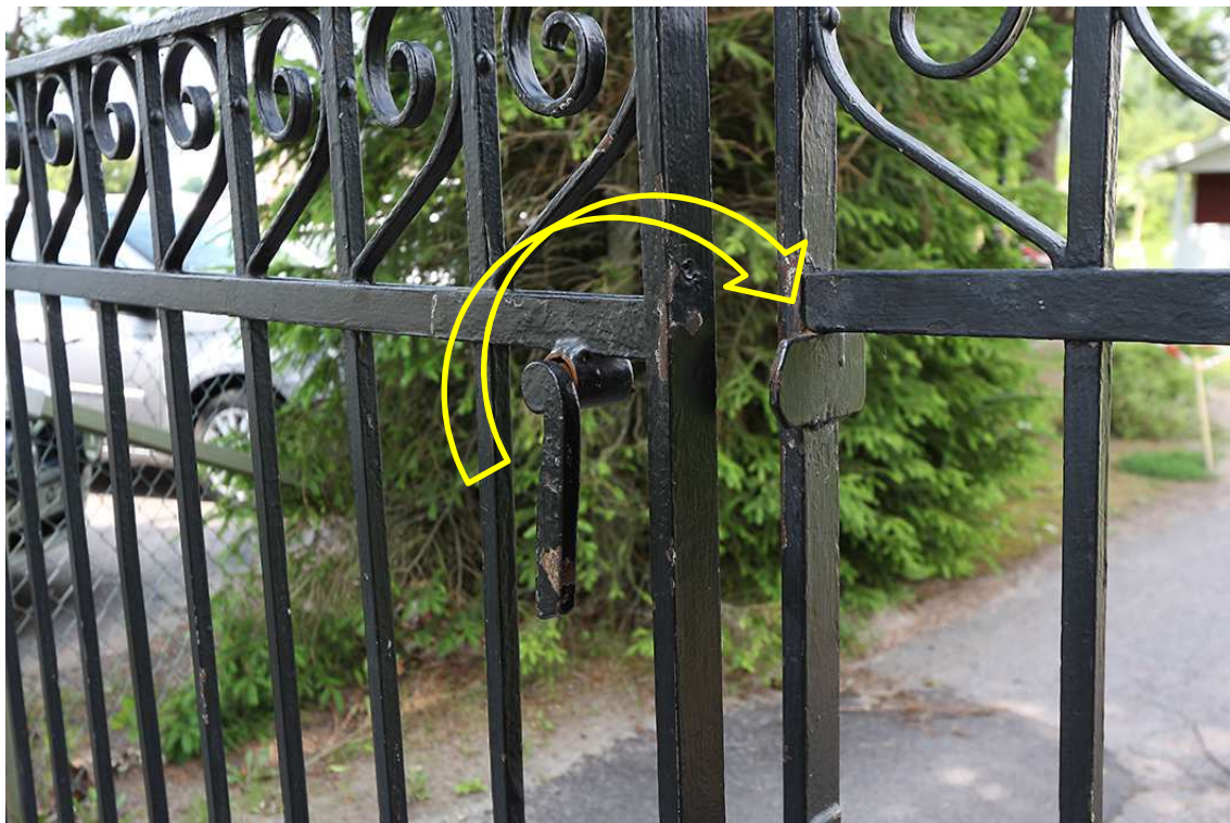
Figur 9. Södra grinden. När grindklinkan lades på järnet på utsidan hade grinden en tendens att själv åka utåt, klinkan ramlade då ned och grinden och klinkan hamnade då i detta läge. Grinden kunde därefter med lätthet öppnas inåt. Gul pil i bilden illustrerar hur klinkan ska läggas över järnet.
