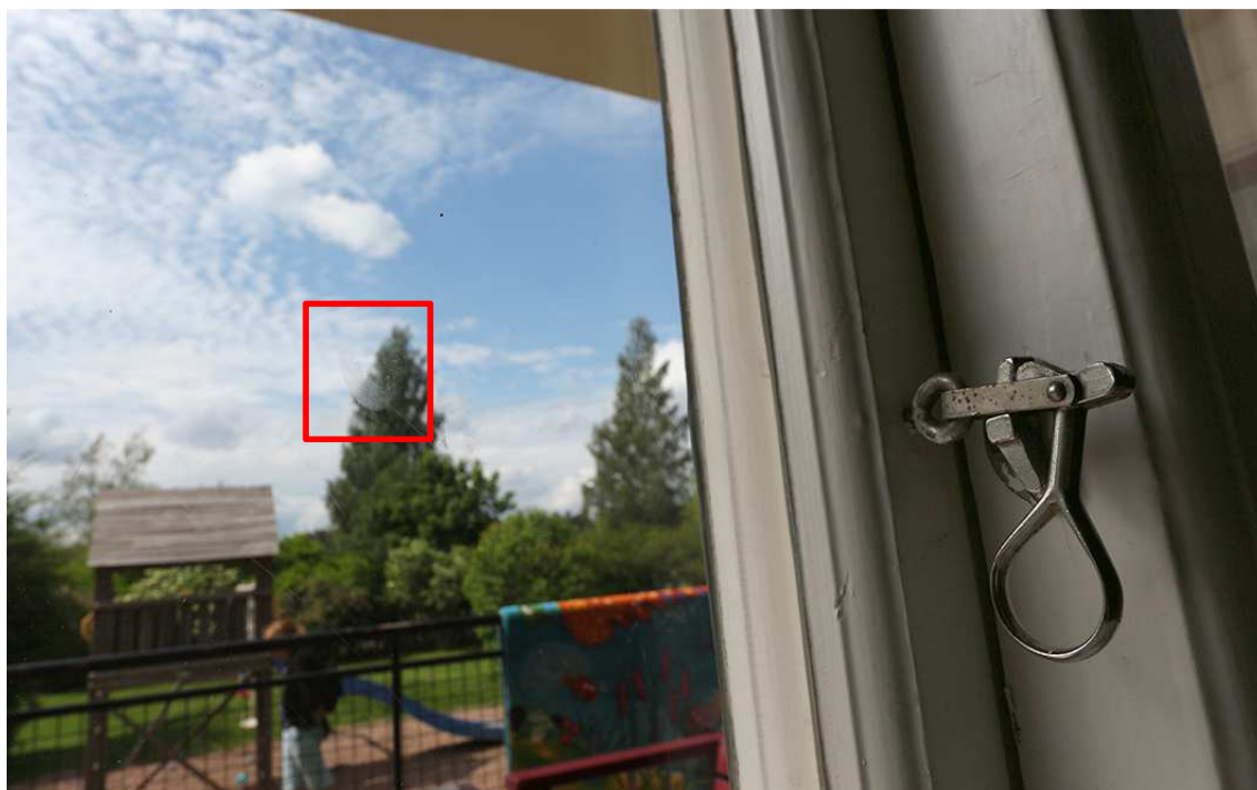
Figur 23. Nedre fönsterhakarna vid fönstret där altanbordet står. Hakarna är påhaspade och fingeravtryck ses på glaset (röd ruta).
