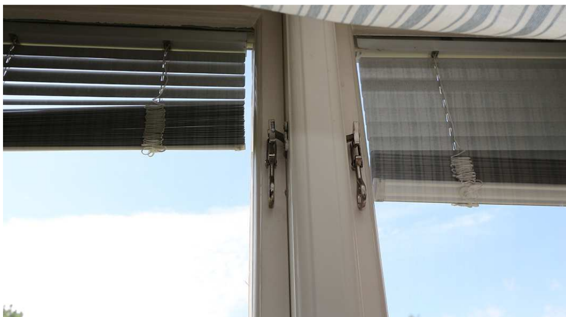
Figur 24. De övre fönsterhakarna vid fönstret där altanbordet står. Hakarna hänger löst och är inte på hakarna.
