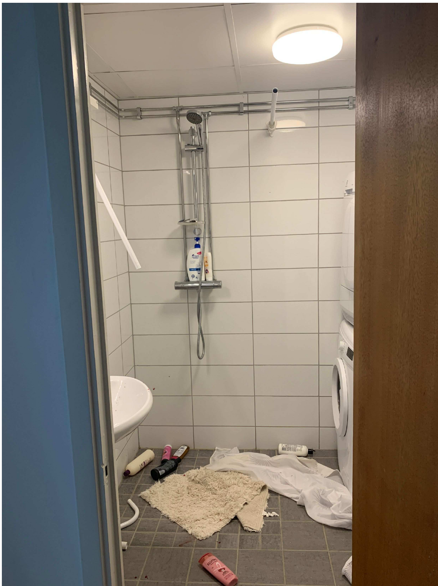
3. Badrummet förstört av Ala
