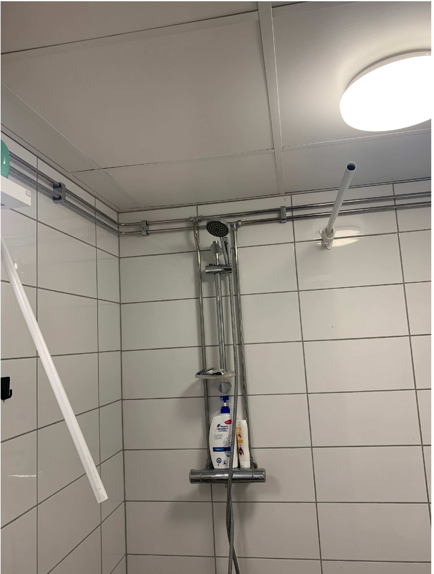
4. Badrummet förstört av Ala
