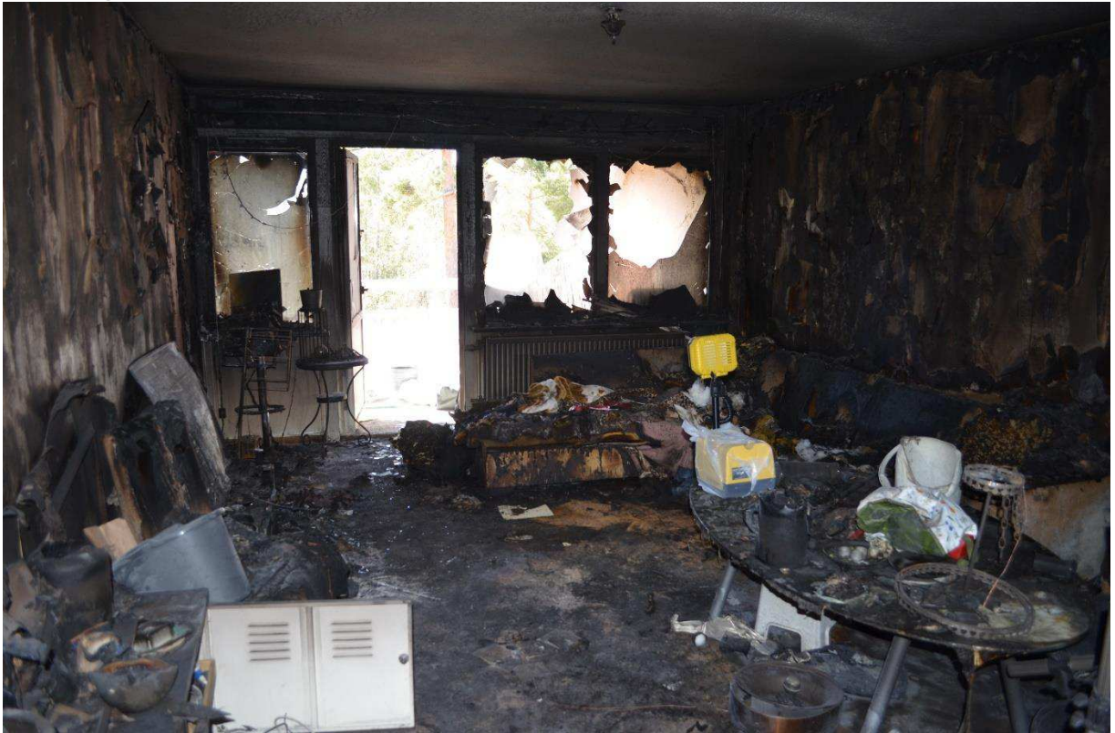
Bild 1 - Brandskador i vardagsrum. Fotat vid platsbesök 2022-05-06
