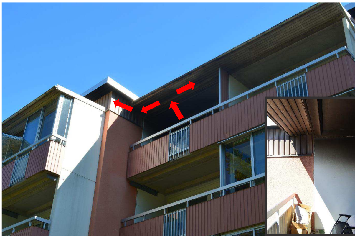
Bild 2 - Branddrabbad lägenhet våning 3. Innanför balkong finns det brandskadade sovrummet. Röda pilar visar principskiss över risk för brandspridning upp mot balkongtak och ovanliggande vindskonstruktion Infälld till höger: Balkong med balkongtak med ventilerad takfot i trä. Fotat vid platsbesök 2022-05-06
