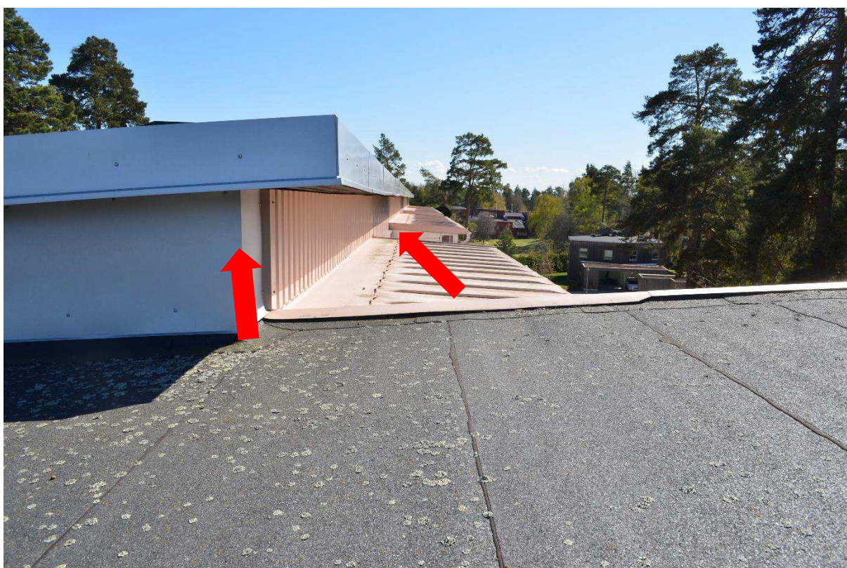
Bild 3 – Principskiss risk för spridning mot vindskonstruktion, forts. Fotat vid platsbesök 2022-05-06
