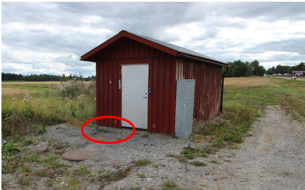
Bild 1. Pumphuset. Brandresterna markerade. Fotograferat i sydlig riktning.
