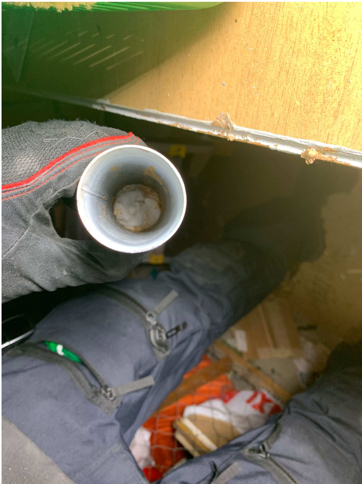
23. Rör 3: Rör 2: Innehållande förmodat packat hushålls/toalettpapper i botten samt liknande brun formodad tätningsmassa som omsluter delar av vissa utav rören.
