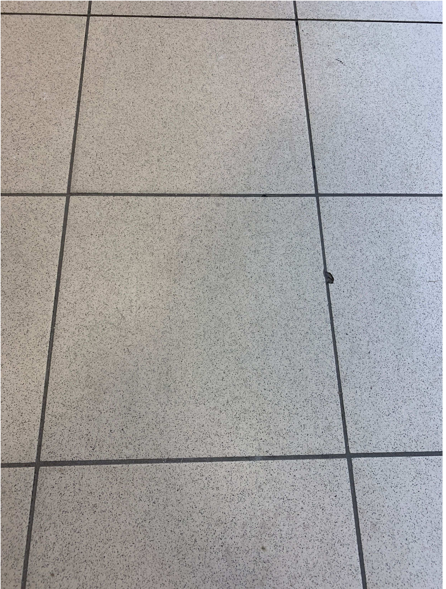
14. Närbild på skada o golvet närmast kassan.
