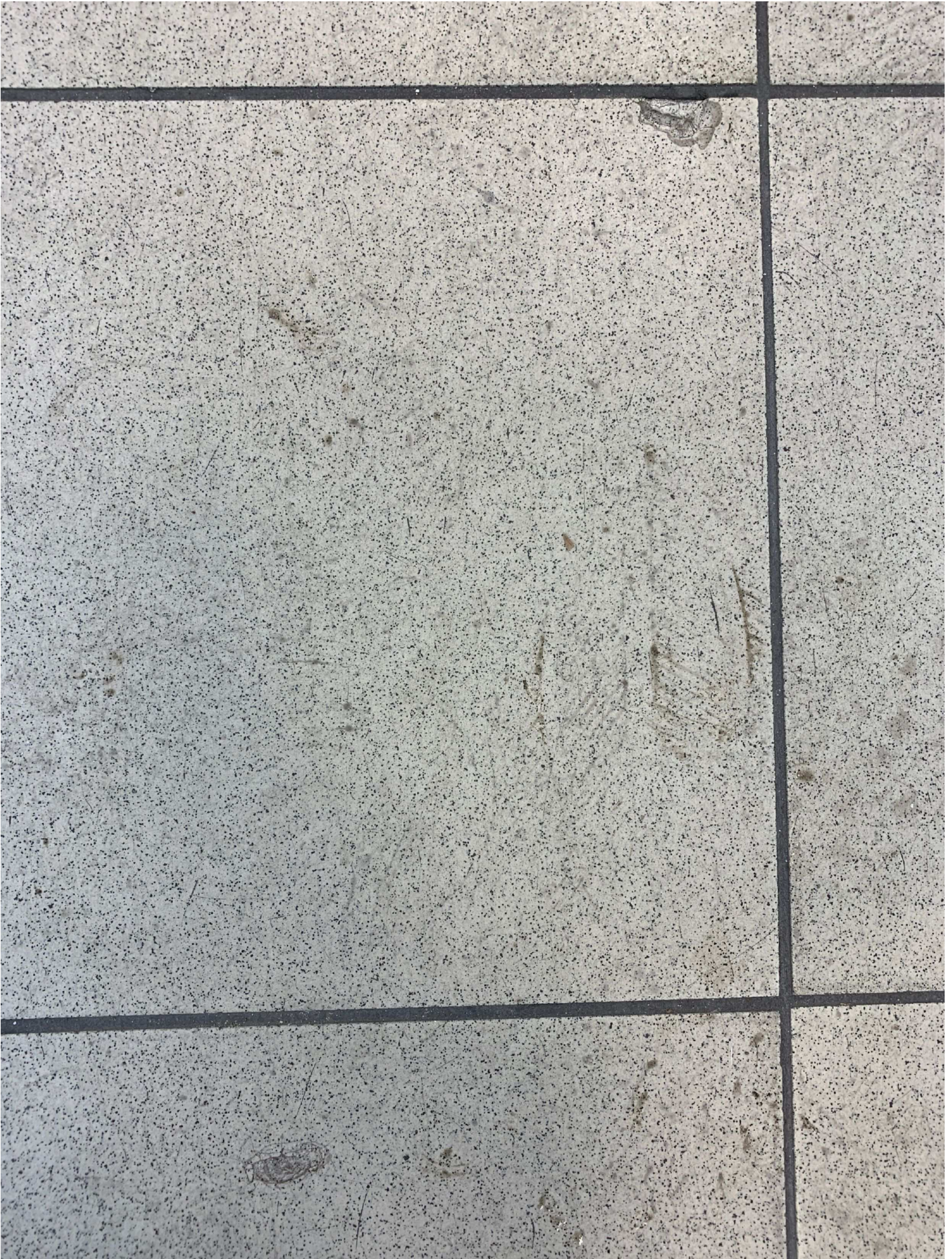
3. Ytterligare närbild på skadorna som i föregående bilder, i golvet längs bort från kassan.
