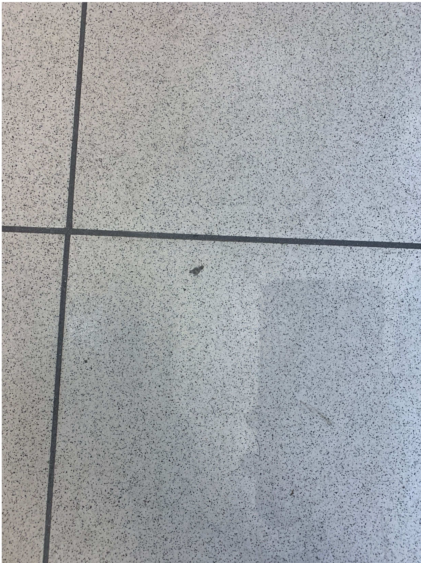
15. Närbild på skada i golvet närmast kassan.
