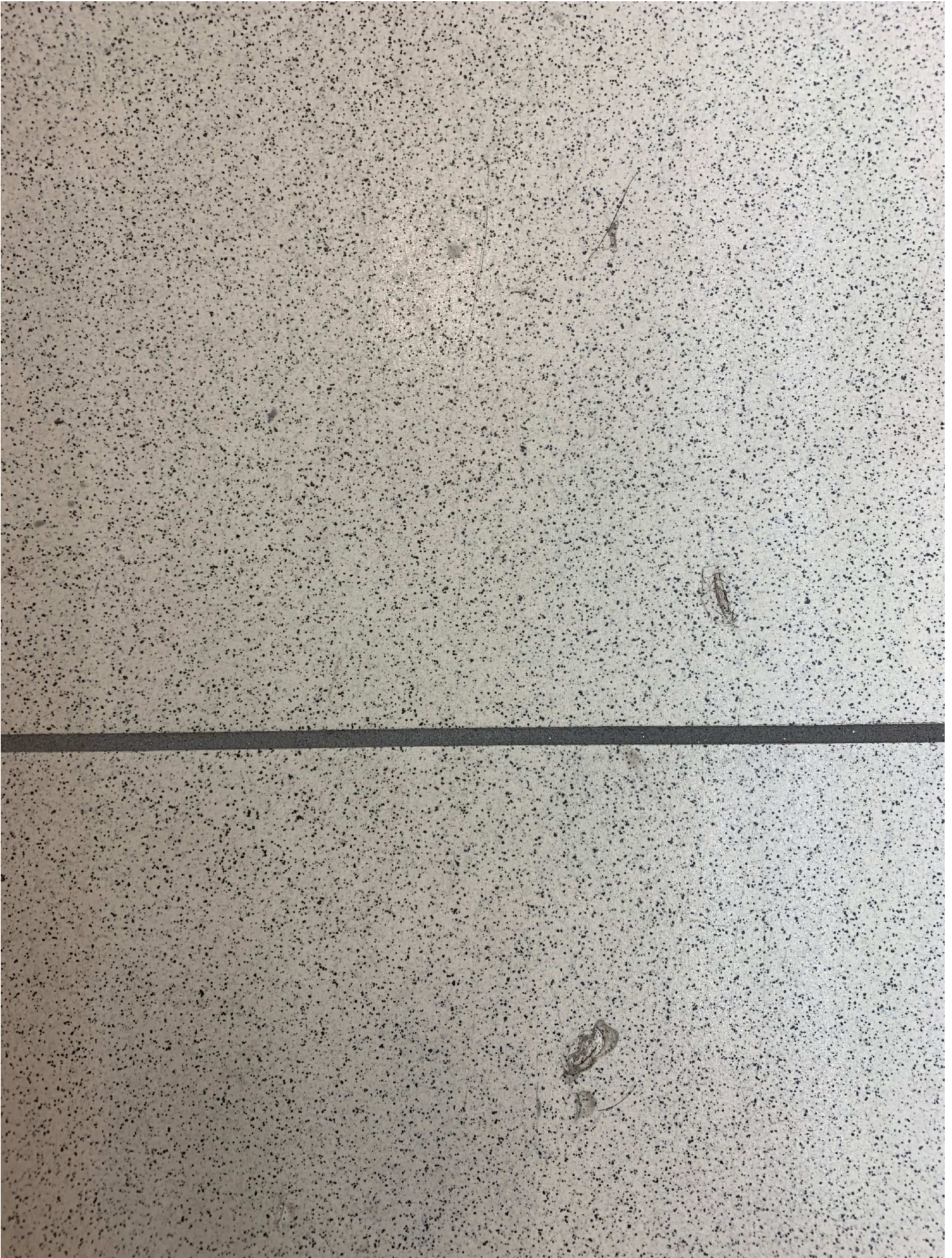
6. Närbild på skadorna i golvet närmast kassan.
