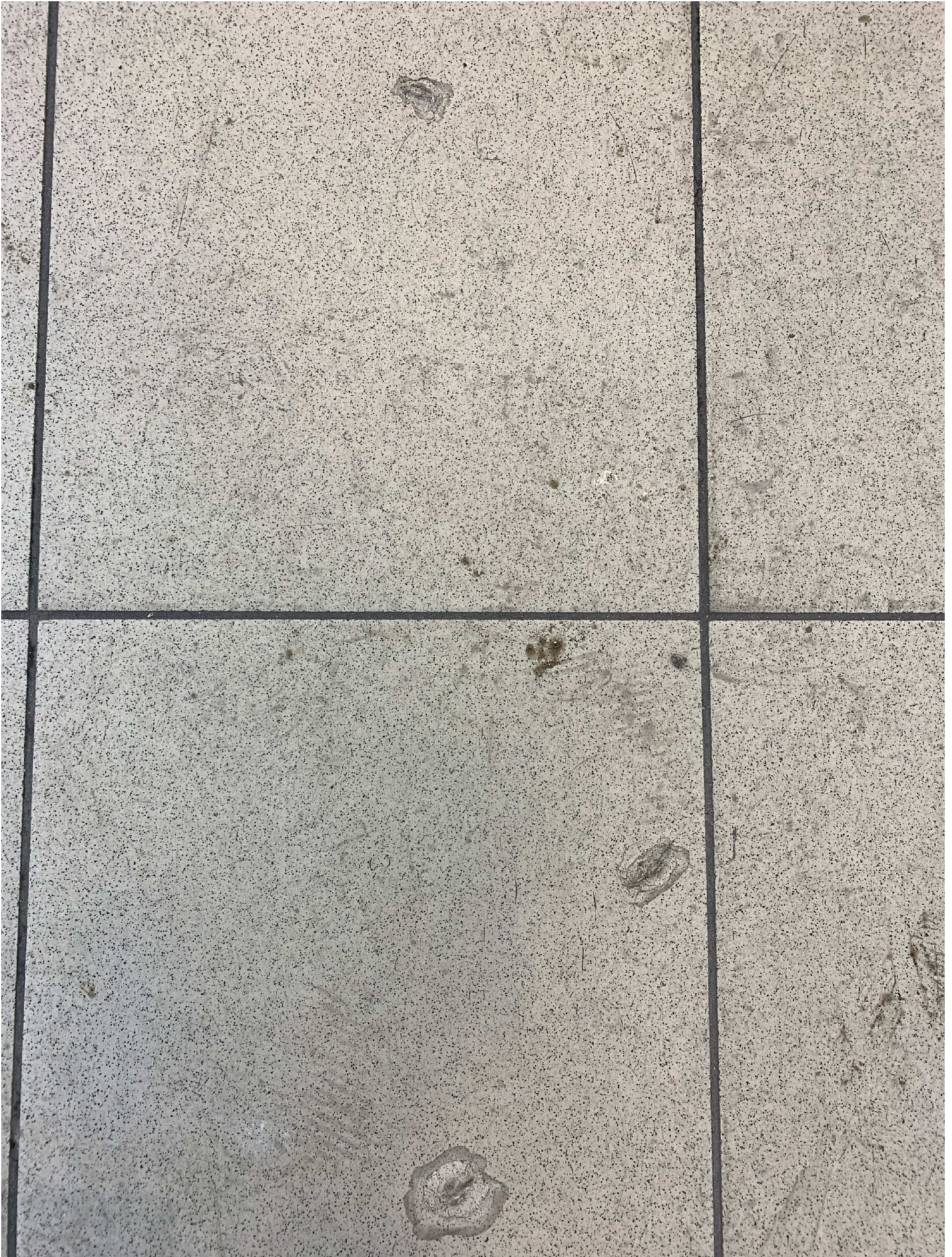
4. Ytterligare närbild på skadorna som i föregående bilder, i golvet längs bort från kassan.
