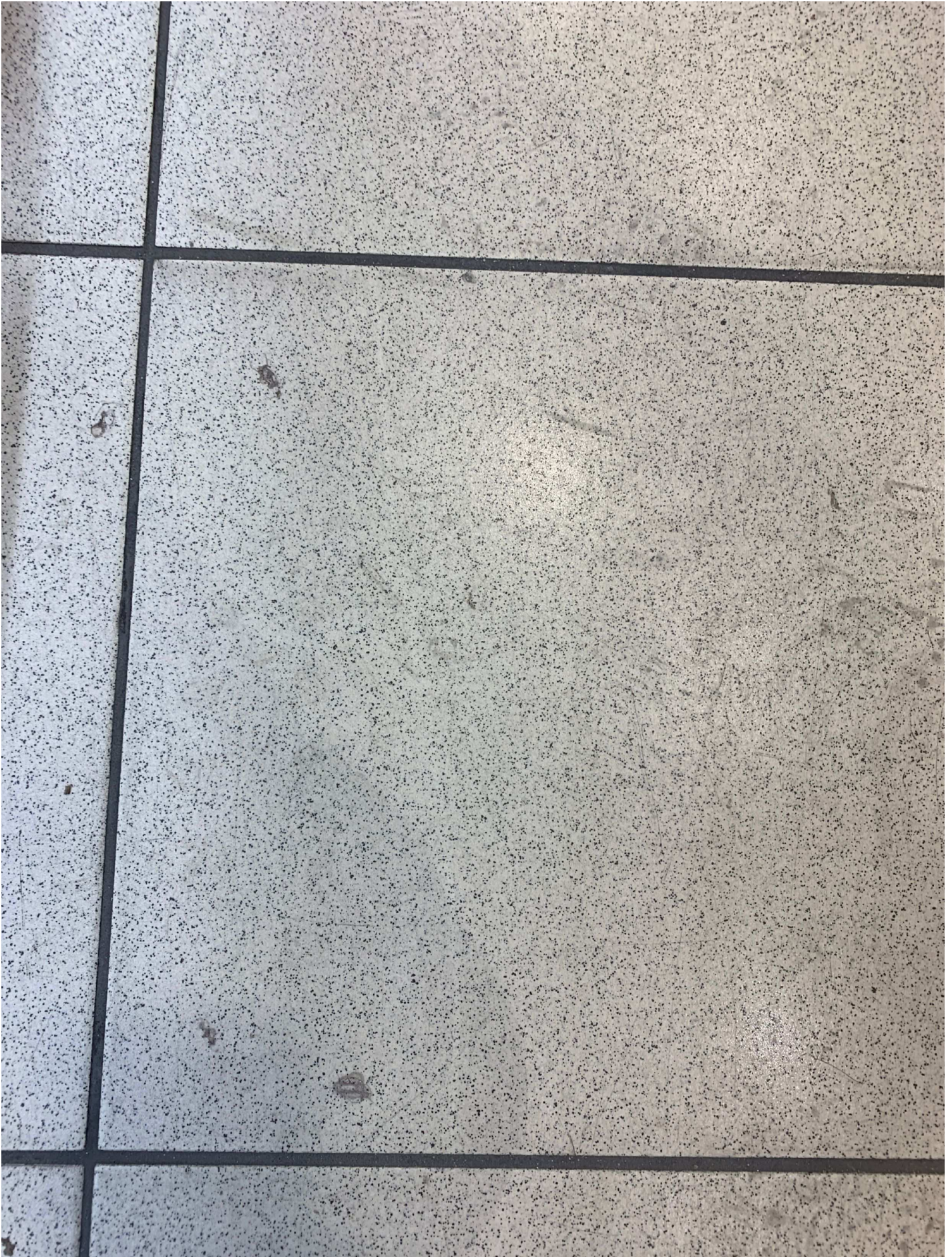
10. Närbild tagen på skadorna från översiktsskildern i föregående bild.
