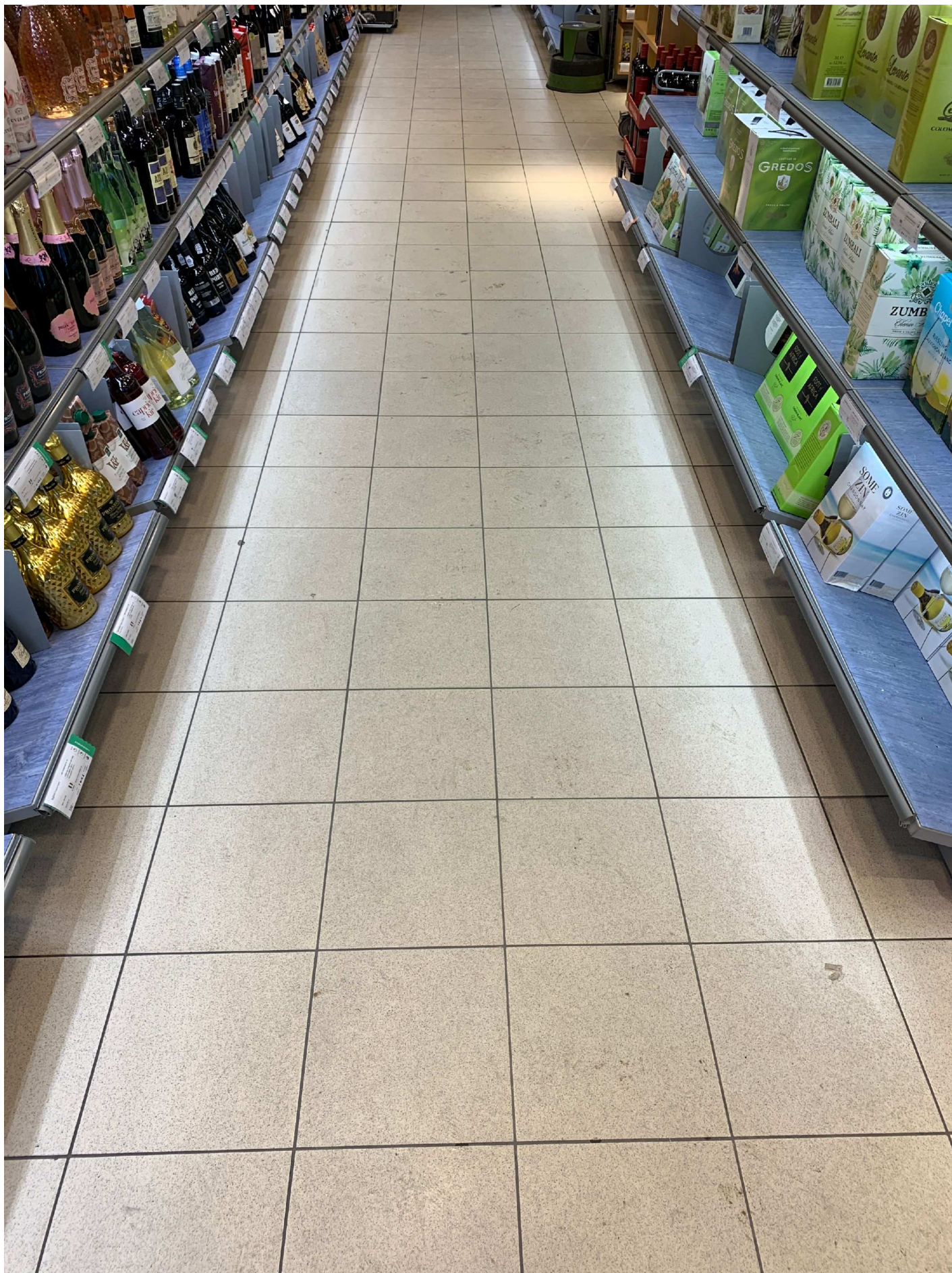
1. Översiktsbild på skadorna i golvet. Bilden tagen vid hyllorna längs bort från kassan.
