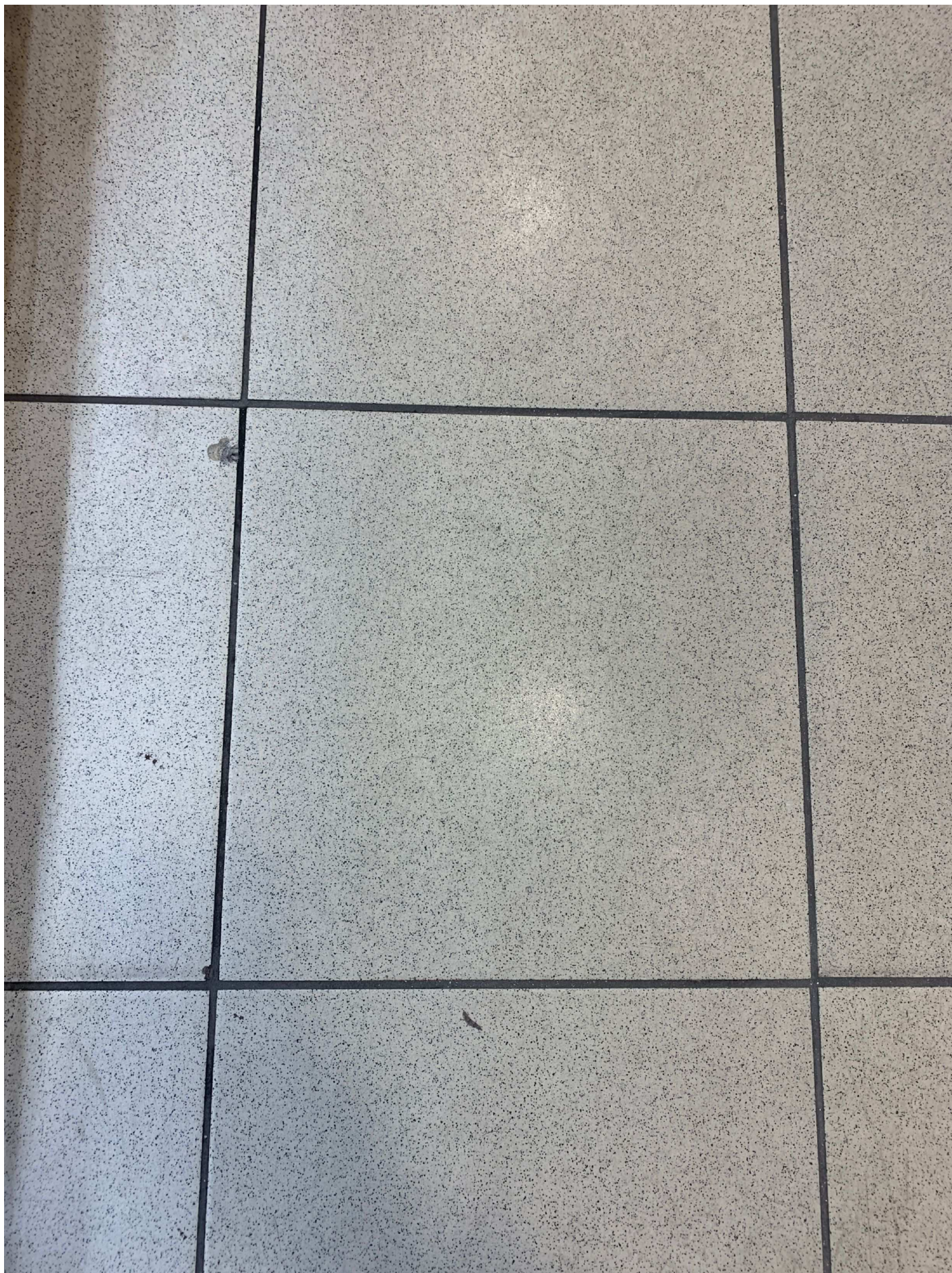
12. Närbild på skada i golvet ner mot hörnet av butiken.
