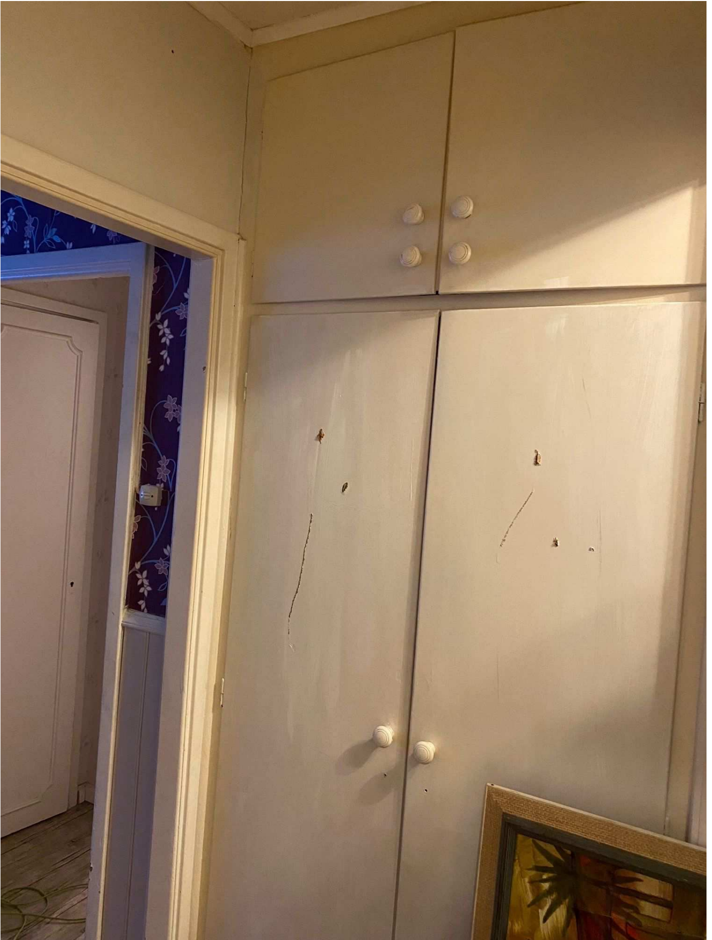
6. Hugg och skador i garderobsdörrar i hallen.
