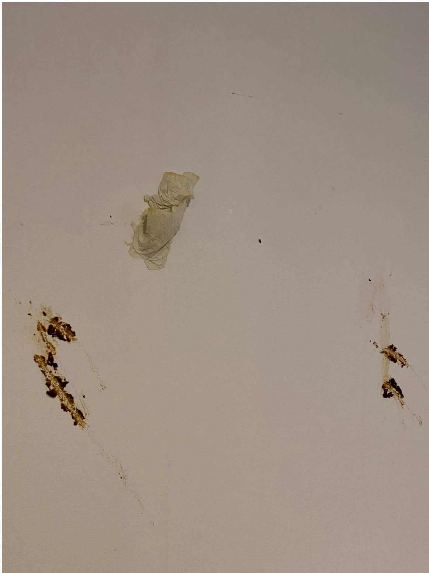
16. Avföring smetat på vägg i vardagsrum. Även en bit torkat papper.
