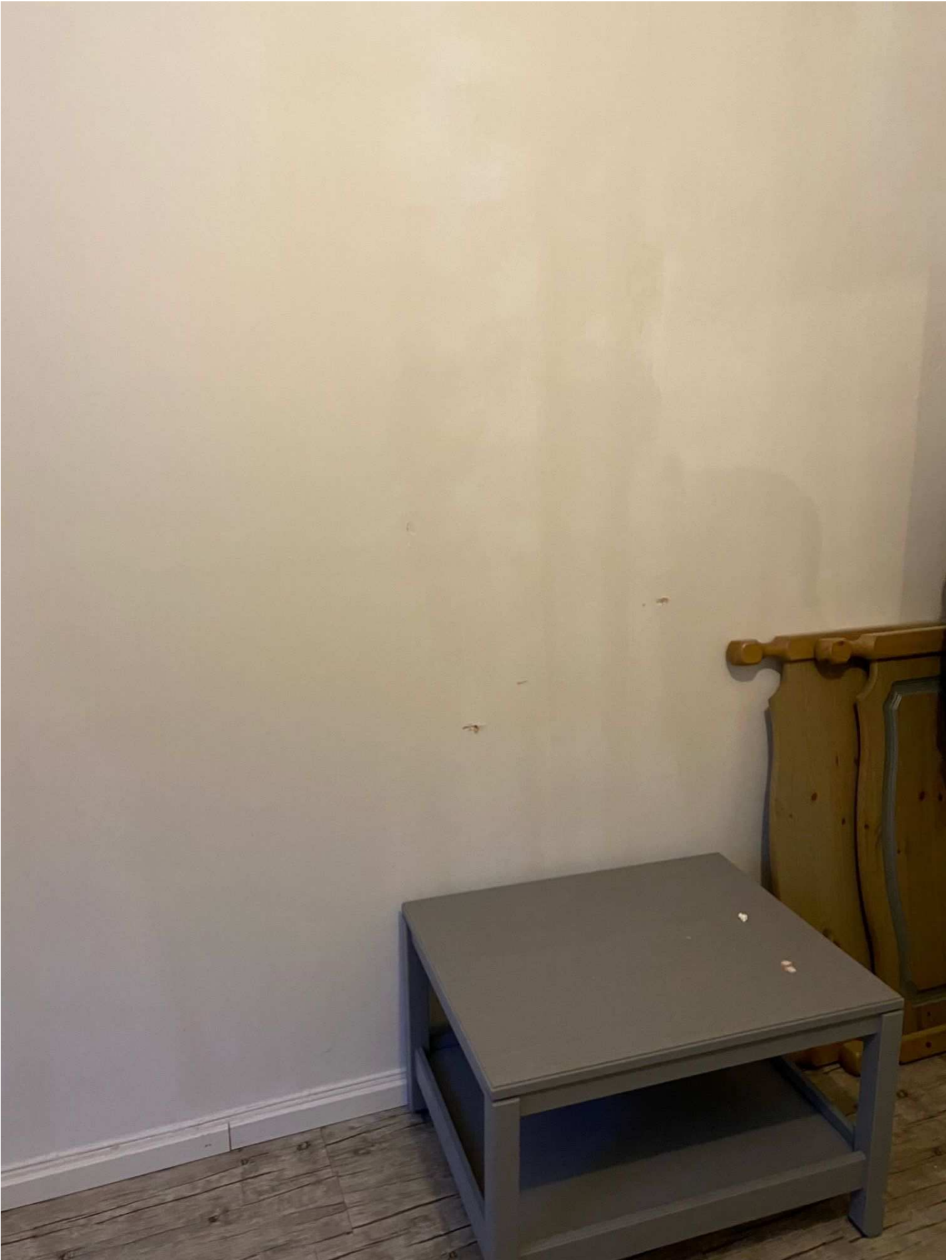
36. Hugg och skador i väggen i sovrummet.
