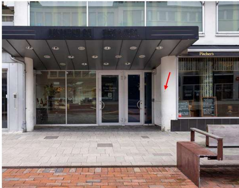
Figur 2. Området till vänster om Pitchers. Skadan i cementpelaren är markerad.
