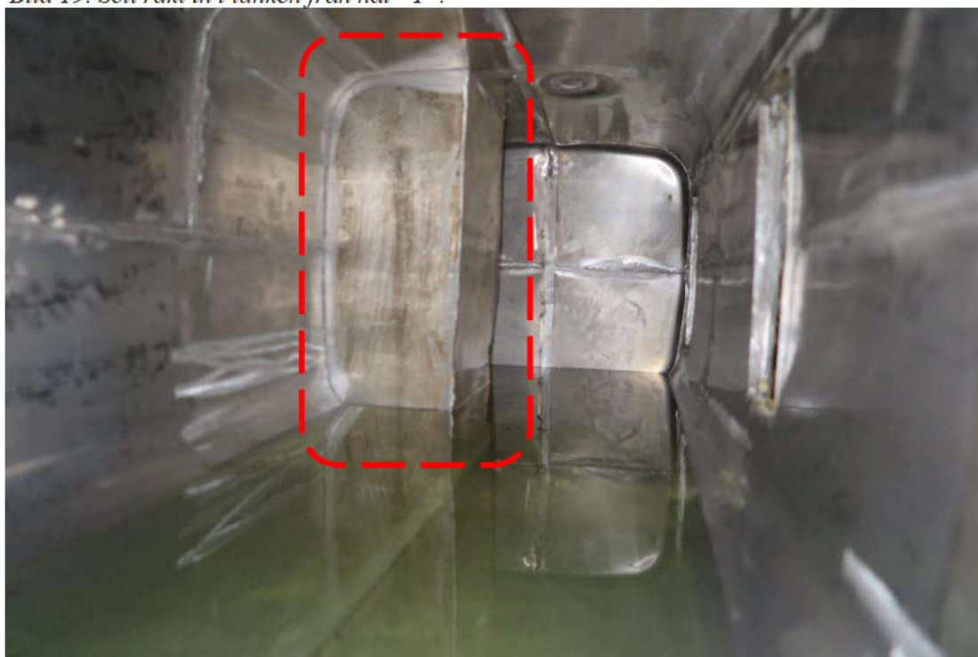
Bild 20. Sett längs med hela tanken från hål "1". Här ses en byggd konstruktion nedanför tankrörets mynning och denna innehöll diesel. När tanklocket öppnas på utsidan ser det ut som att tanken är fylld med drivmedel och väggarna i konstruktionen gör att man inte ser om tanken innehåller något annat än det den är ämnad för. På botten i tanken är det lite diesel.
