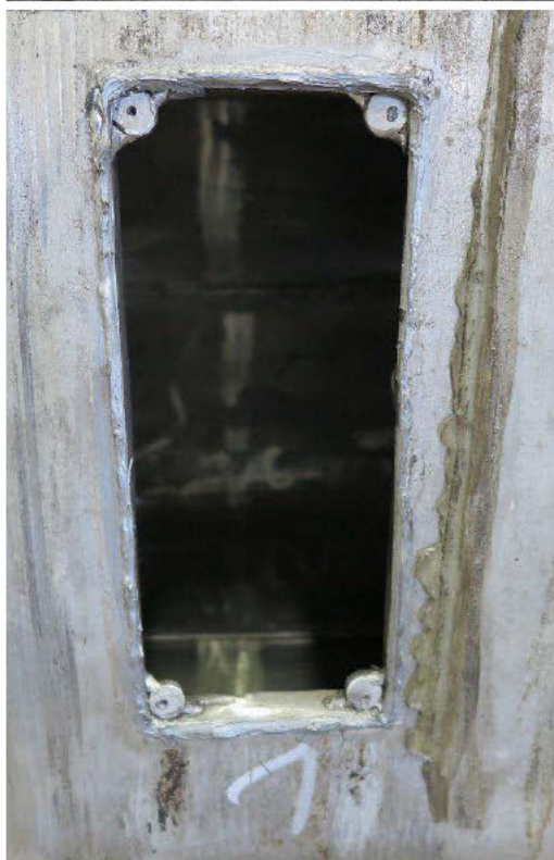
Bild 18. Plåt "1" har lossats och man kan se var skruvarna hade sitt fäste och se in i tanken.
