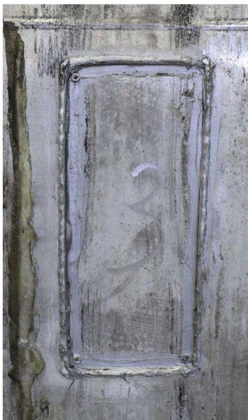
Bild 17. Plåten som täckte hål "3" mäter ca 13cm*30cm. Den är monterad med tre skruvar och silverfärgad fogmassa.
