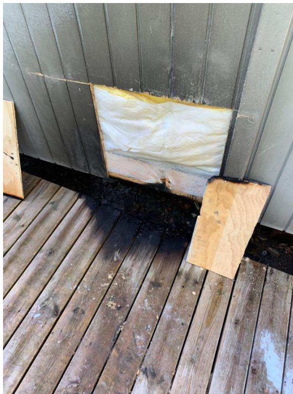
Bild 17. Foto brandplats. Bortsågade bitar av fasaden sidan om skadan. Foto polis Adam Ericson 2023-05-27 kl 16:35:46.
